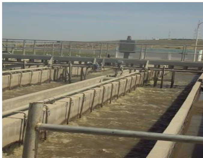
Fig.8. Le dessablage et le déshuilage.
