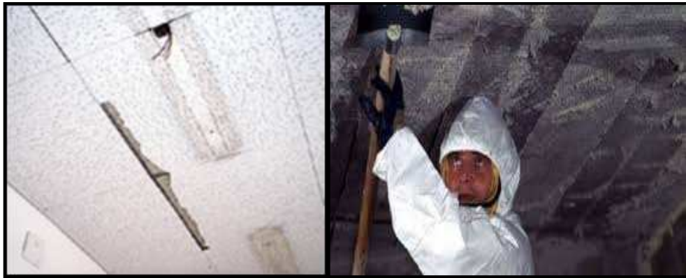
Figure III.4. Utilisation de l'amiante comme de faux plafond et panneaux légers amentifères [25].
