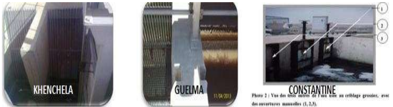
Figure 8 : dégrillage grossier des 3 stations
