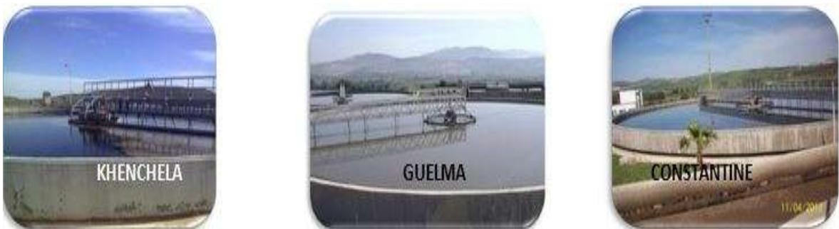
Figure 12 : Clarificateur secondaire des 3 stations
