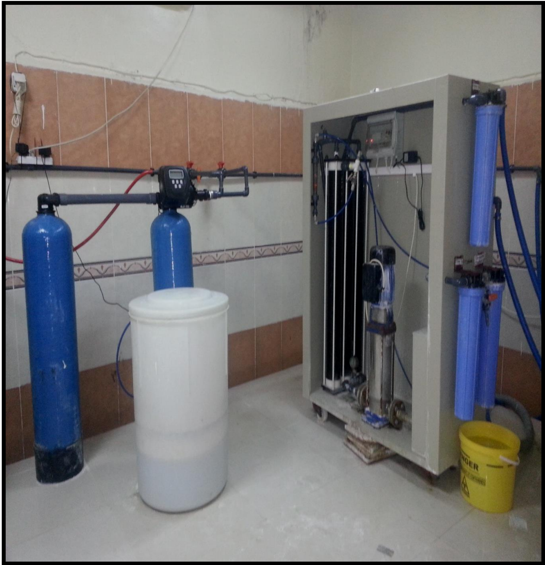
Photo 01 : Station du traitement d'eau
