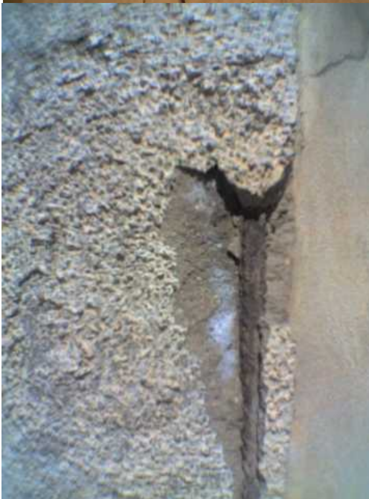
a) Fissuration b) Éclatement localisé
