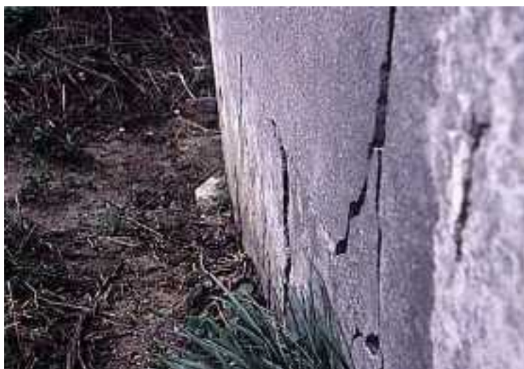
a) Fissuration sévère d'un massif de fondation
