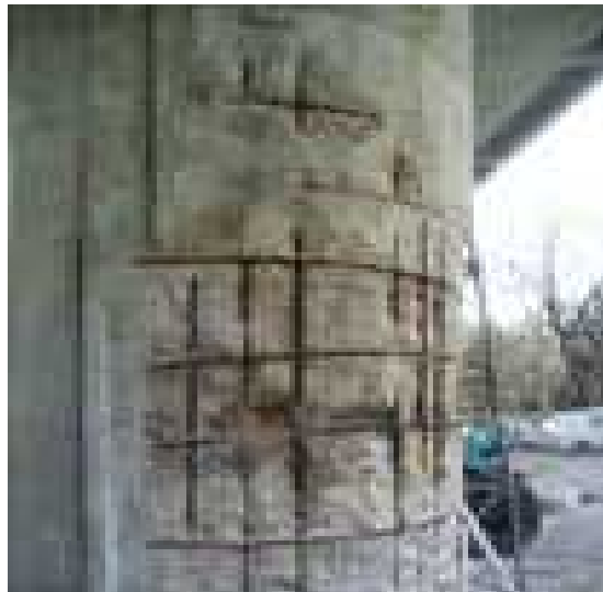
Figure II -28: Corrosion des armatures suite à la carbonatation du béton d'un pilotis.
