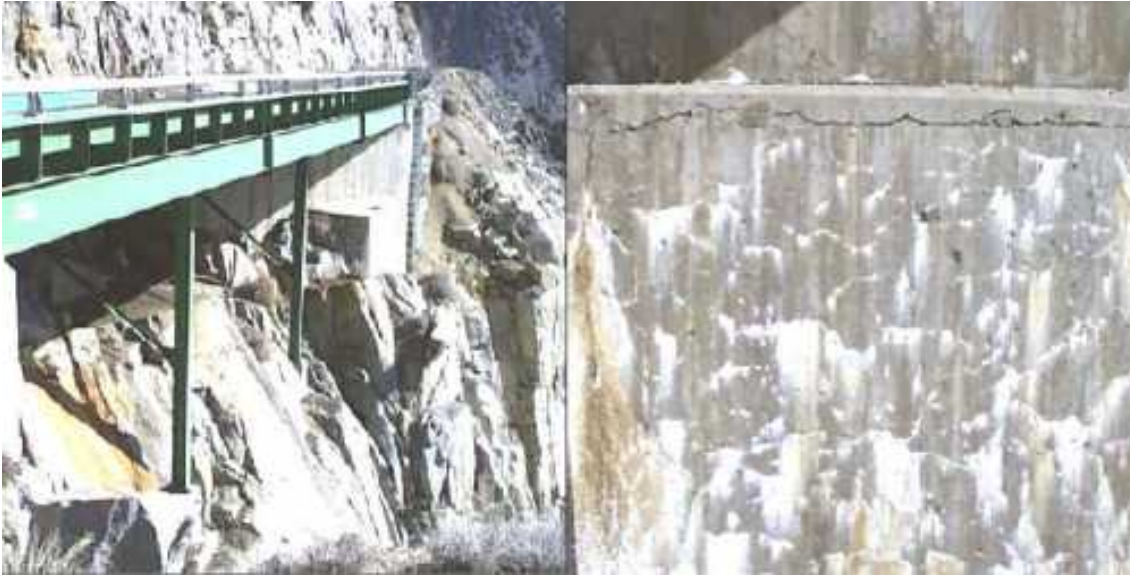
Figure II -2 : Des cas pathologiques d'éléments en béton en contact de sulfate. [2]
