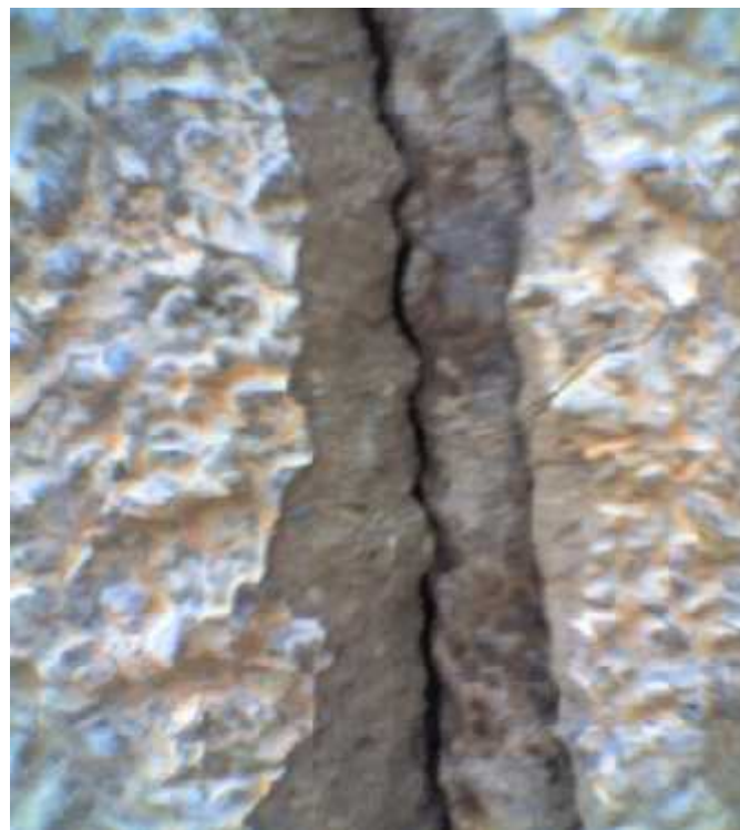
c) Corrosion d'armature.
