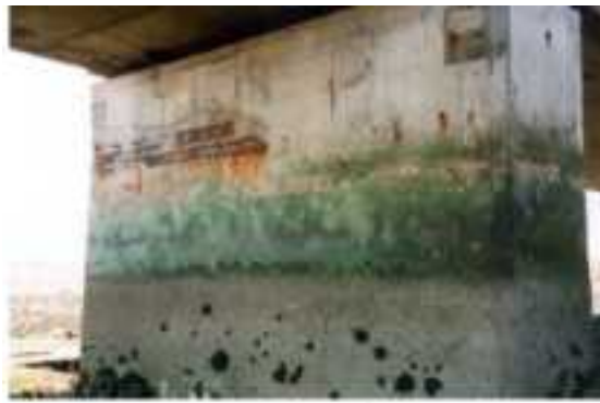
Figure II -14: Quelques photos d'ouvrage en BA dégradés par l'eau de mer. [12]
