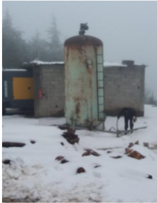
Figure II-5: Le compresseur alimentant les deux niveaux d'exploitation en aire comprimée, filon n°4
