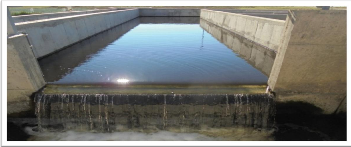
Figure 14 : Bassin de chloration
