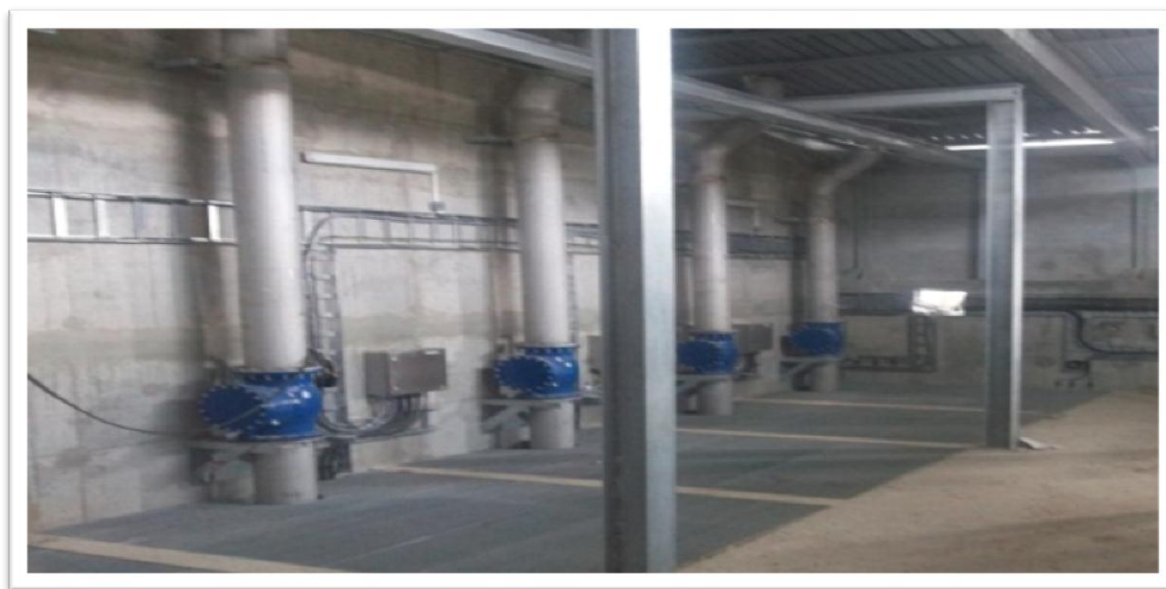
Figure 6 : Poste de relevage
