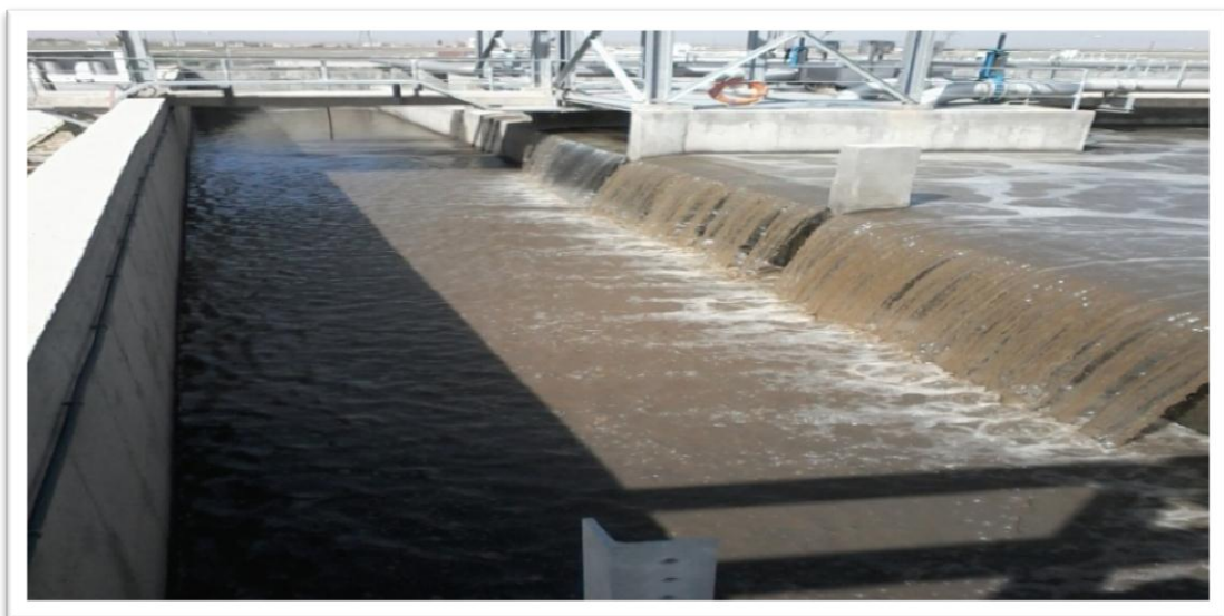
Figure 12 : bassin de dégazage
