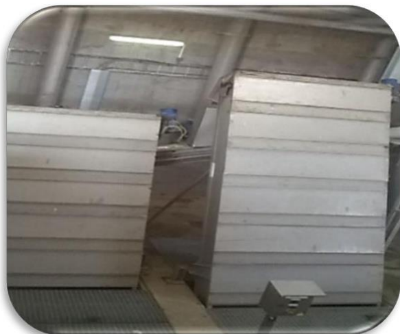
Figure 19 : Le Dégrillage grossier
