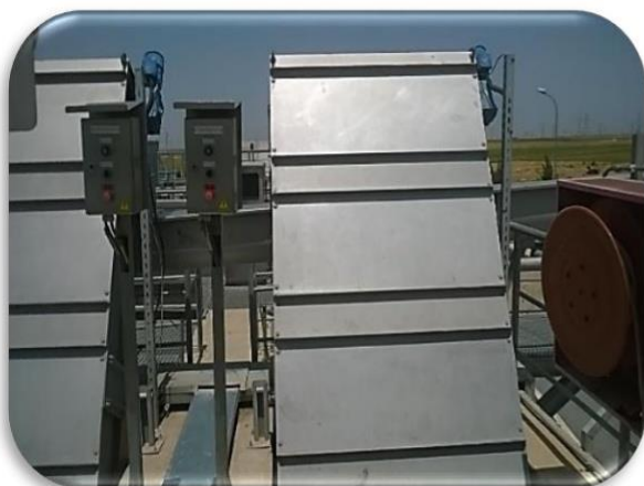
Figure 21 : Le Dégrillage fin.
