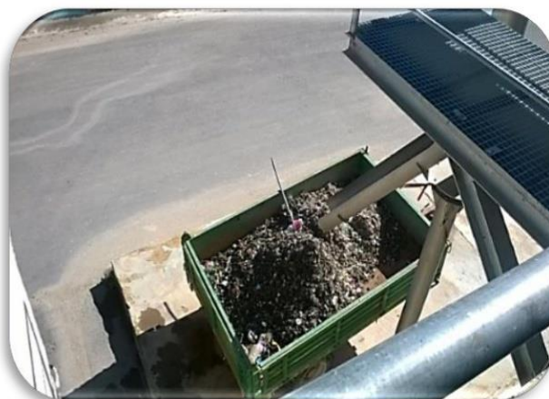
Figure 22 : La baine de déchets de dégrillage fin.
