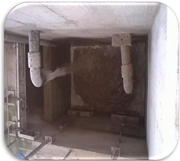
figure 18 : les pompes de relevage
