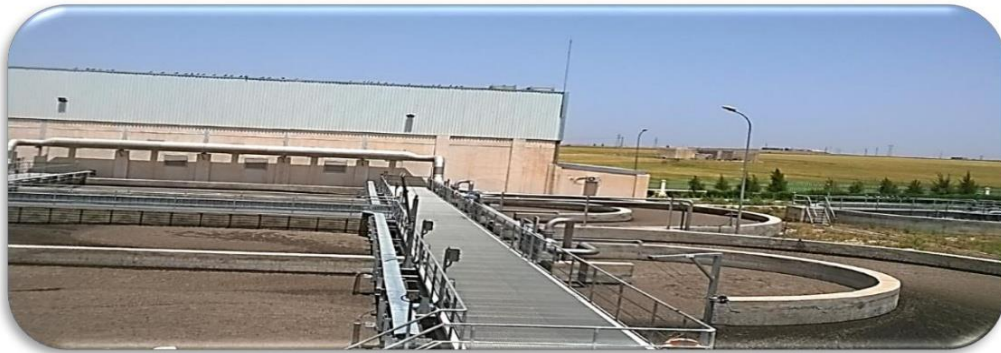
Figure 30 : Le digesteur des boues épaisses
