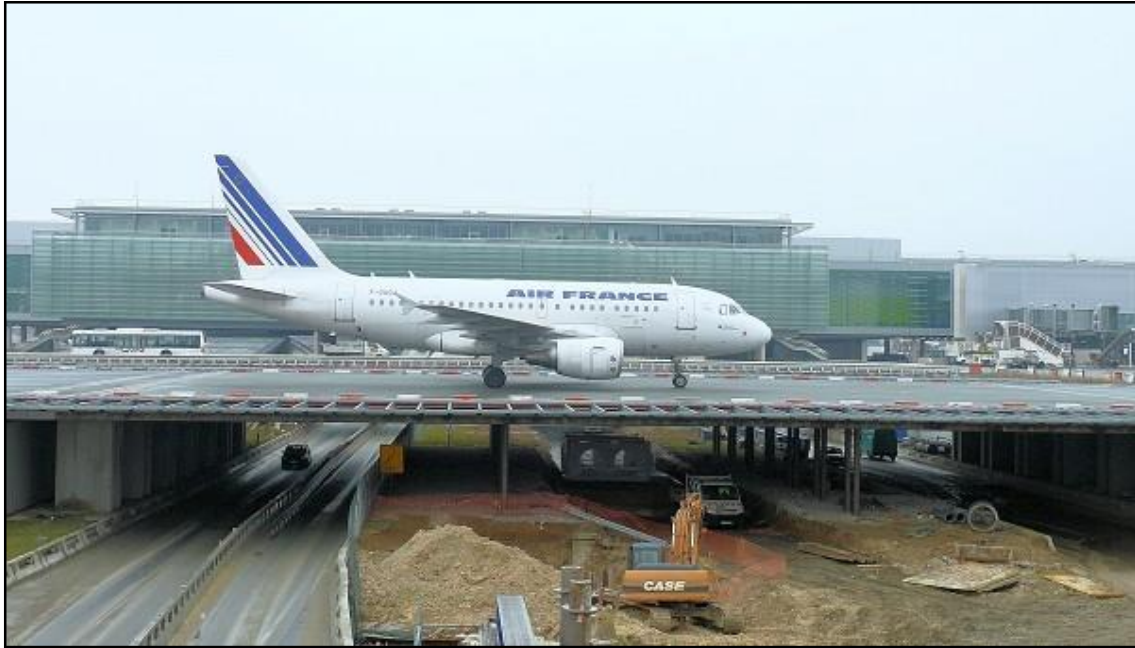
Figure 2. Pont-avion à l'aéroport de Roissy-Charles-de-Gaulle
