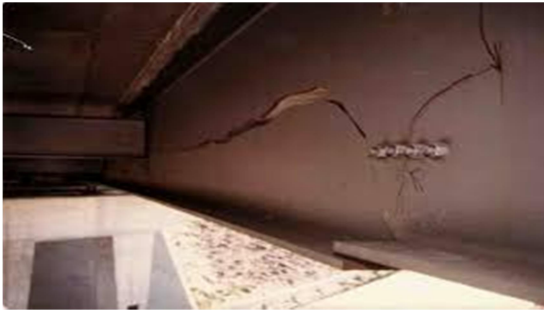
Figure 5. Fissuration d'un pont
