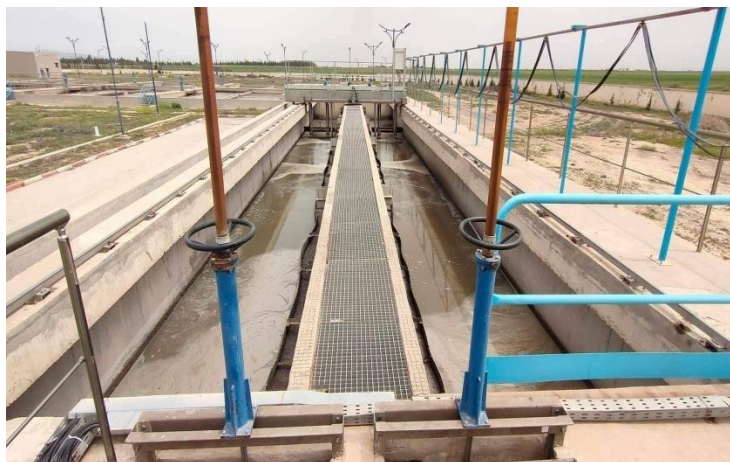
Figure 3 : Désableur et déshuileur(STEP Kais, 2022)
