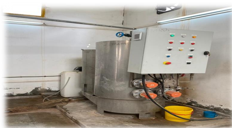
Figure 14 : La chaudière à la vapeur et compresseur d'air.
