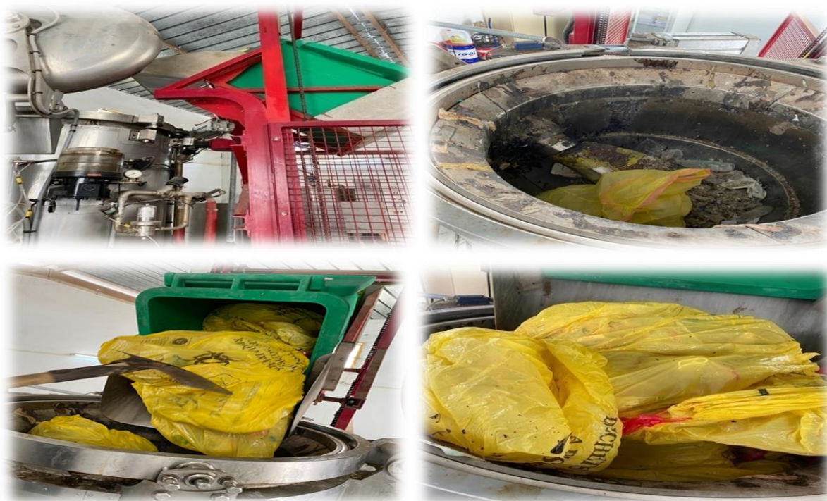
Figure 13 : Chargement et broyage de DASRI dans le banaliseur.
