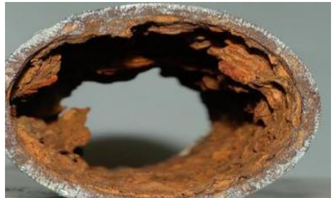
Figure I-4 : Image représentative d'une Corrosion généralisée très avancée
