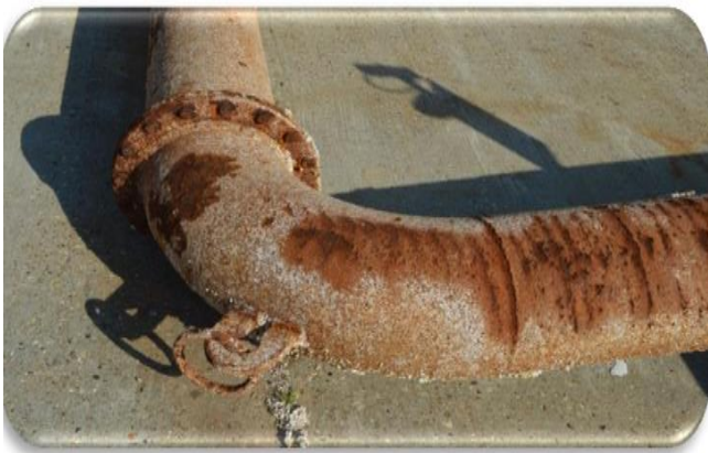
Figure I-3 : Corrosion généralisée exemple d'une pipe de transport
