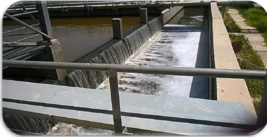
Figure II.12 : Le Bassin de dégazage
