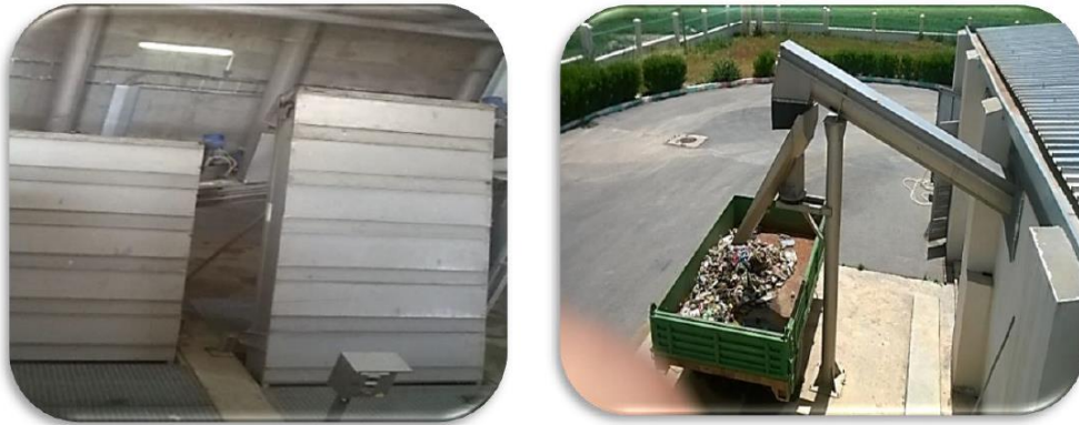
Figure II.7 : Le Dégrillage grossier
