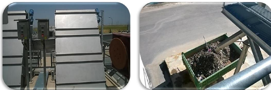
Figure II.8: Le Dégrillage fin.
