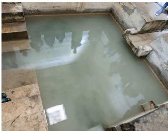
Figure II.4: Bassin de décantation.
