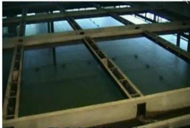
Figure II.3 : Bassin de Floculation
