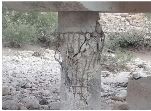
Photo I.96: Flambement de la pile
