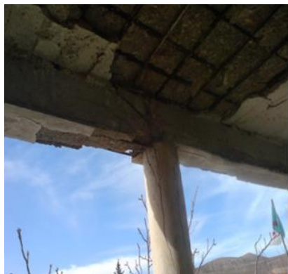
Photo I.22: Rupture des jonctions poteaux poutres
