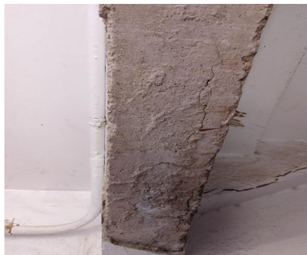
Photo I.13 : Fissuration des poteaux
