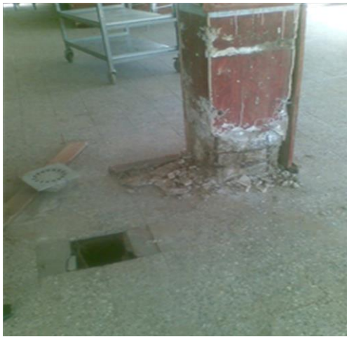
Photo I.41: Dégradation du béton due à la corrosion des armatures à cause de la présence d'eau.
