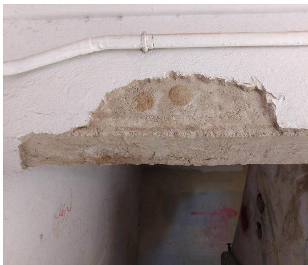
Photo I.12: Fissuration des poutres
