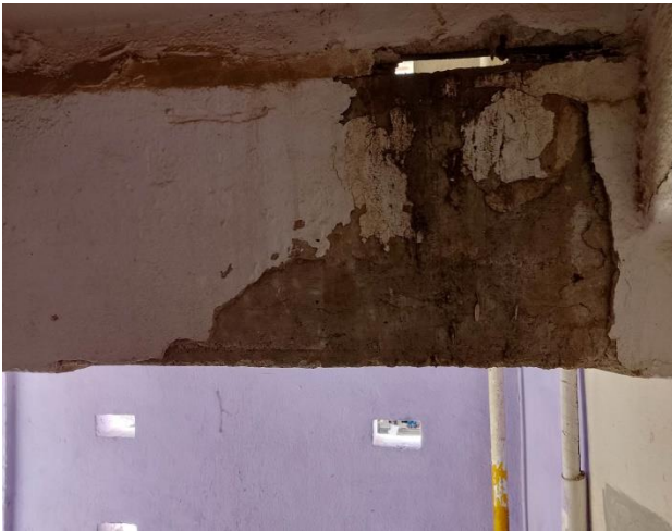
Photo I.14 : Ruissellement sur les poutres
