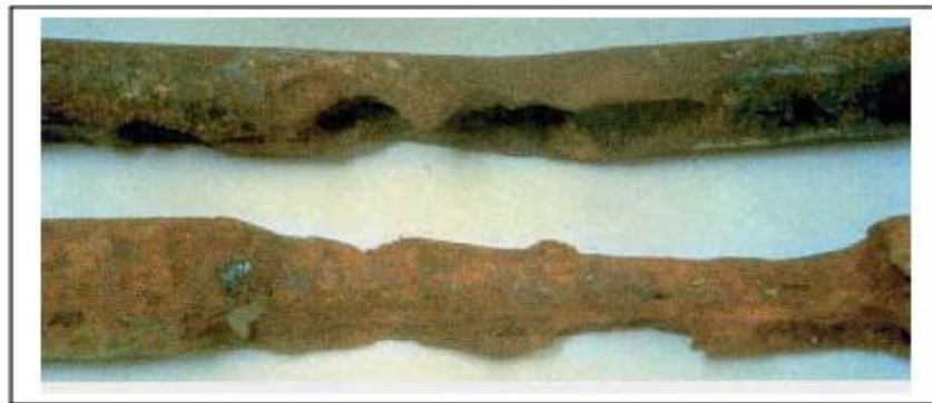
Figure I.10: Piqûre profonde causée par une attaque de chlorure (Extrait de http://www.vectorgroup.com/CorrosionOverview.pdf )
