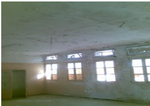
Photo I.43: Dégradations intérieures dues aux infiltrations de la dalle pleine.
