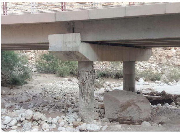
Photo I.95: déclatement du béton
