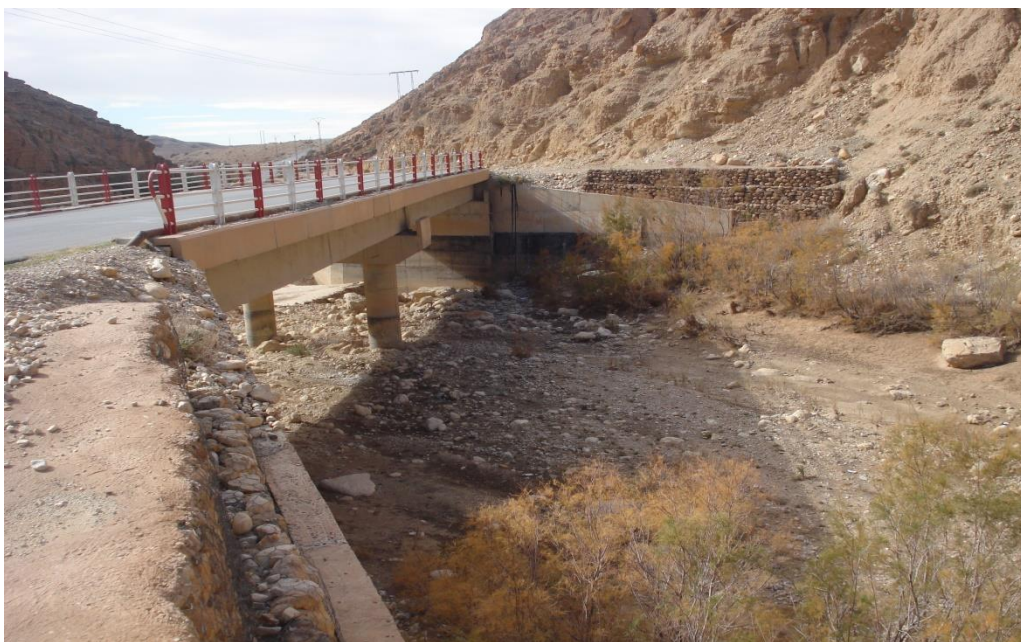
Photo I.94: ouvrage d'art sur oued siear commune de chechar CW 08 PK27+000:
