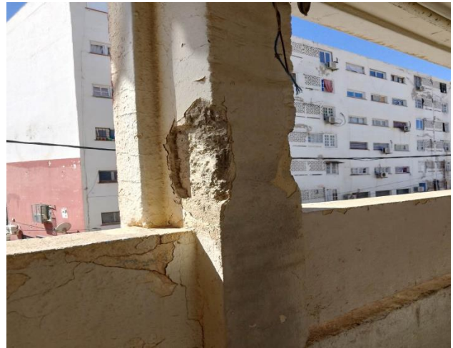
Photo I.15 : dégradation aux niveaux des poteaux
