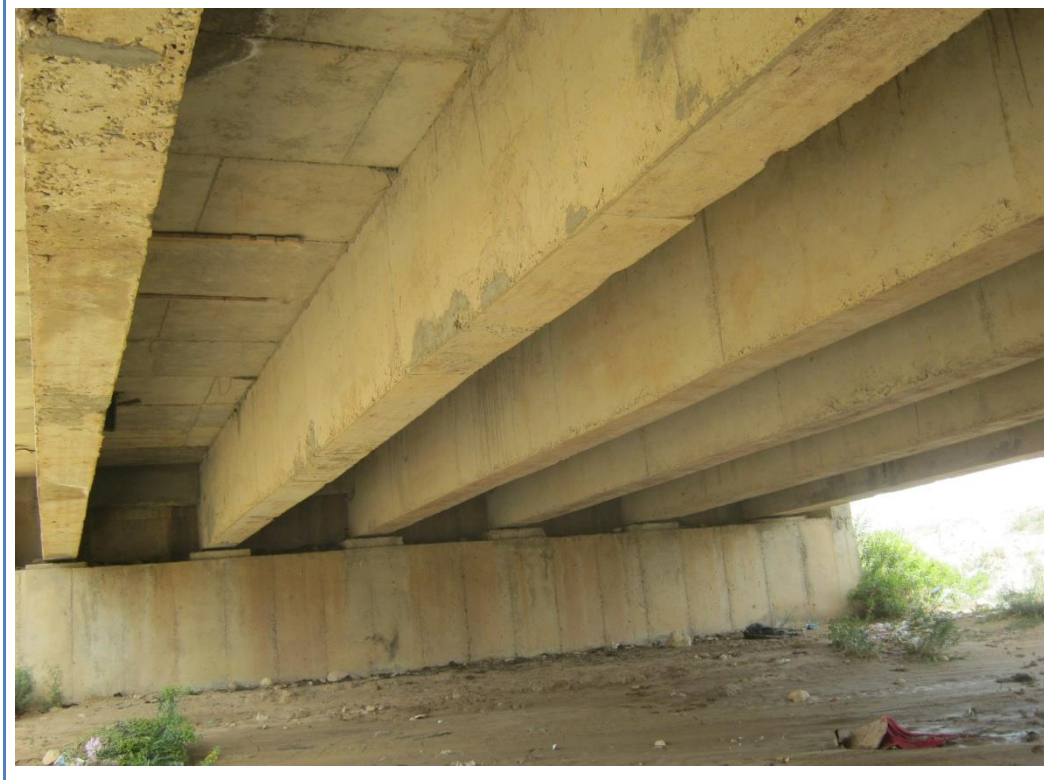
Photo I.70 Superstructure : Intrados de dalle, poutres et entretoise d'about. Infrastructure : Mur de front de culée sens Khenchela.
