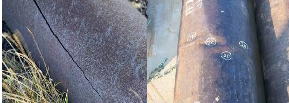
a. Crack (E. Casas et al., 2024)
