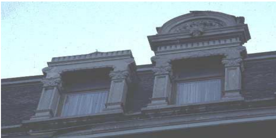
Figure II.15 : Le fronton de gauche a basculé...voir l'effet à la figure suivante...situation inchangée à ce jour...)[2]
