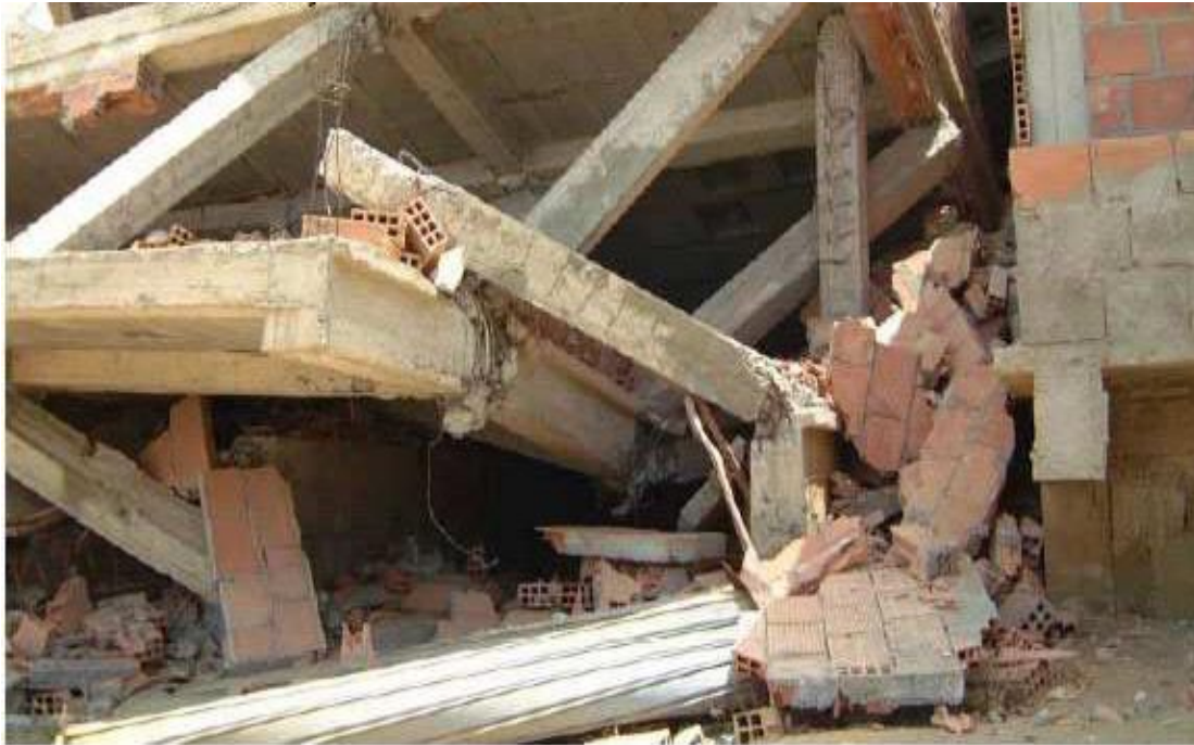
Figure II.18 : Ossature en portique de béton armé en construction et effondrée (Boumerdes, 2003).
