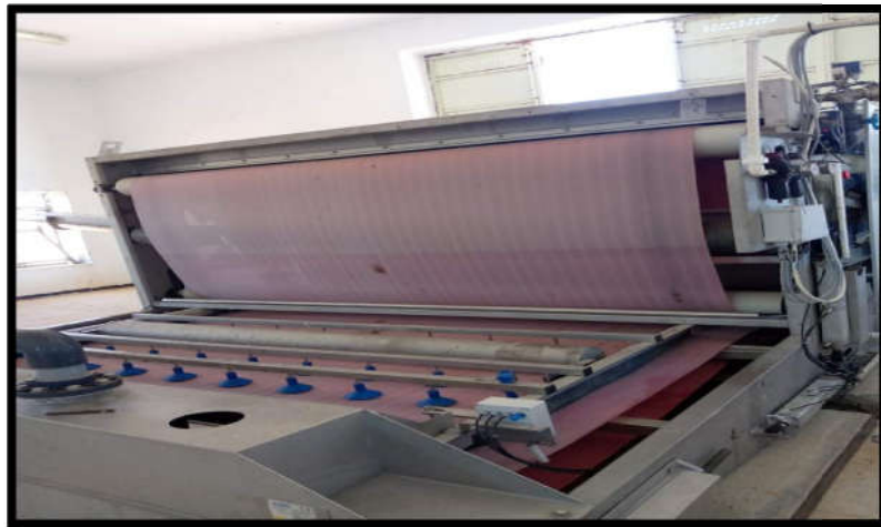
Fig.12: La déshydratation mécanique des boues dans la STEP
