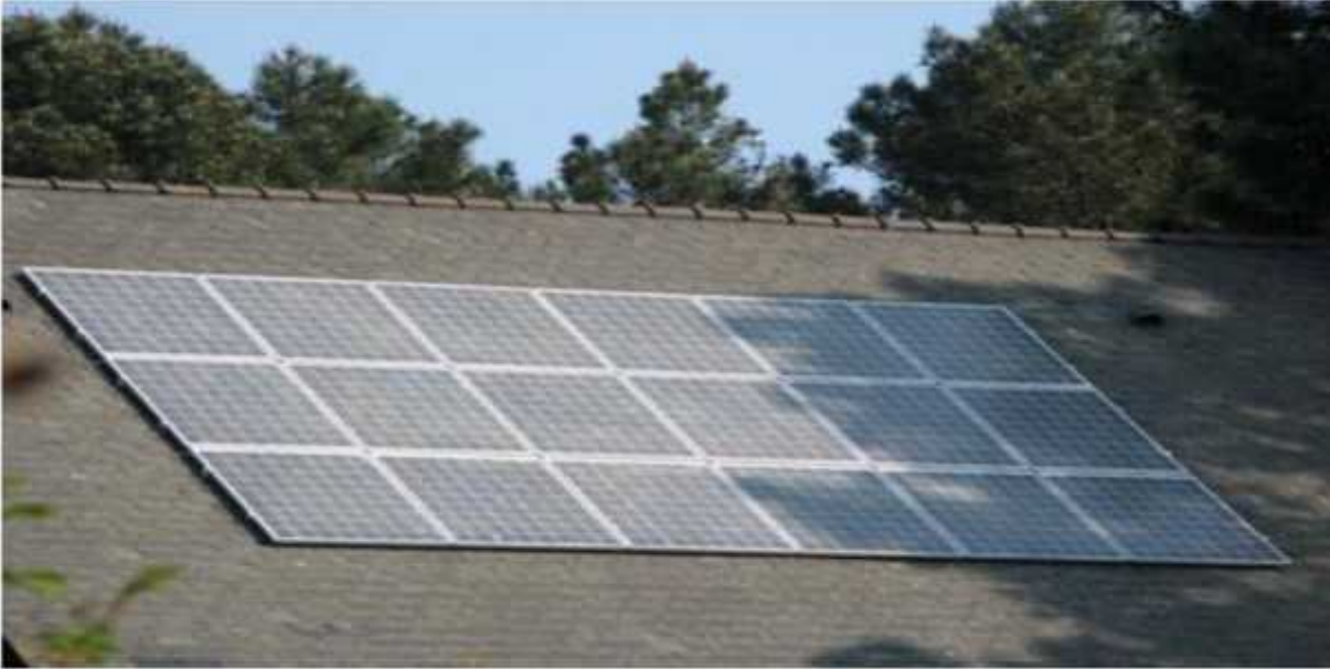
Figure II.9 : PV dans des contritions partiellement ombragées causées par l'ombre d'un arbre.
