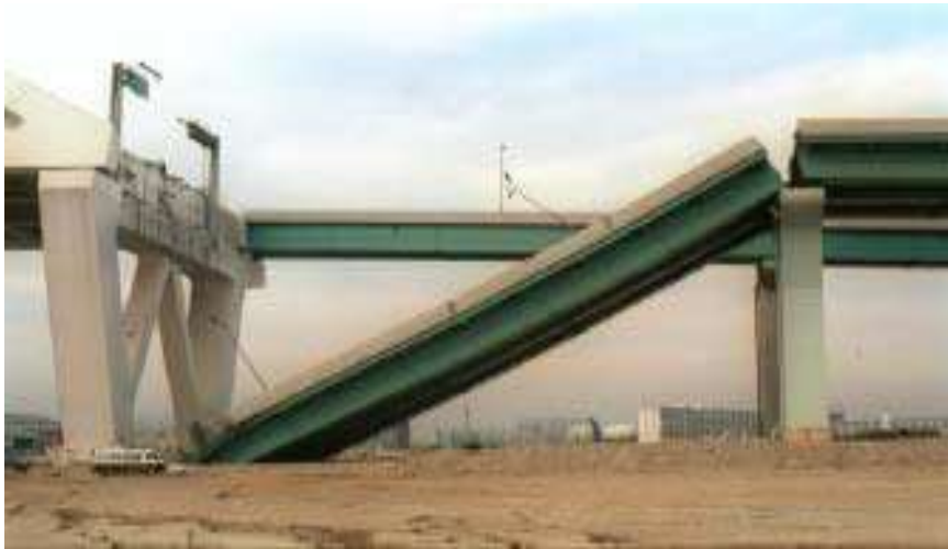
Figure 1.10 : Effondrement de travée dû à une perte d'appui (Kobé 1995) (Tiré de SML, 2002)
