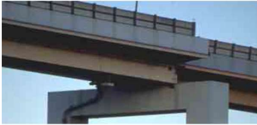
Figure 1 .5 : déplacement latéral du tablier séisme Kobe 1995 (Kobe 1995)
