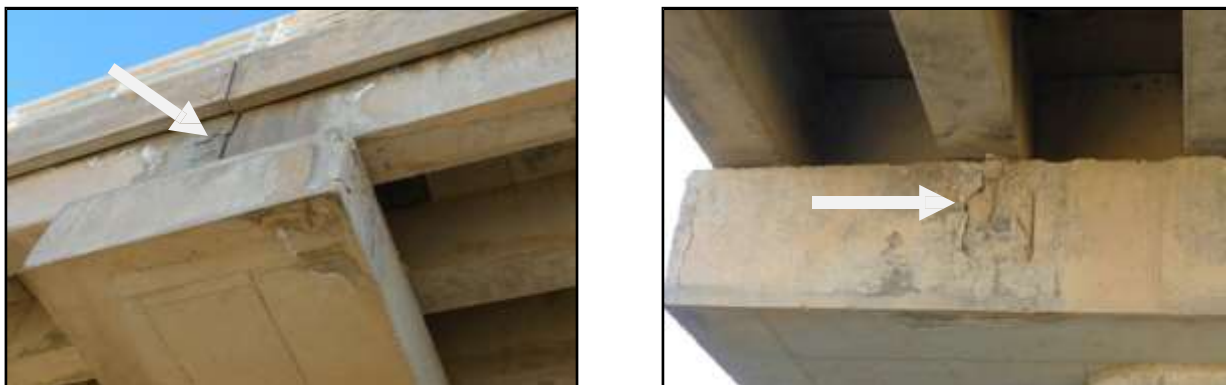
Figure 4.14 : laitances et ségrégation de béton
