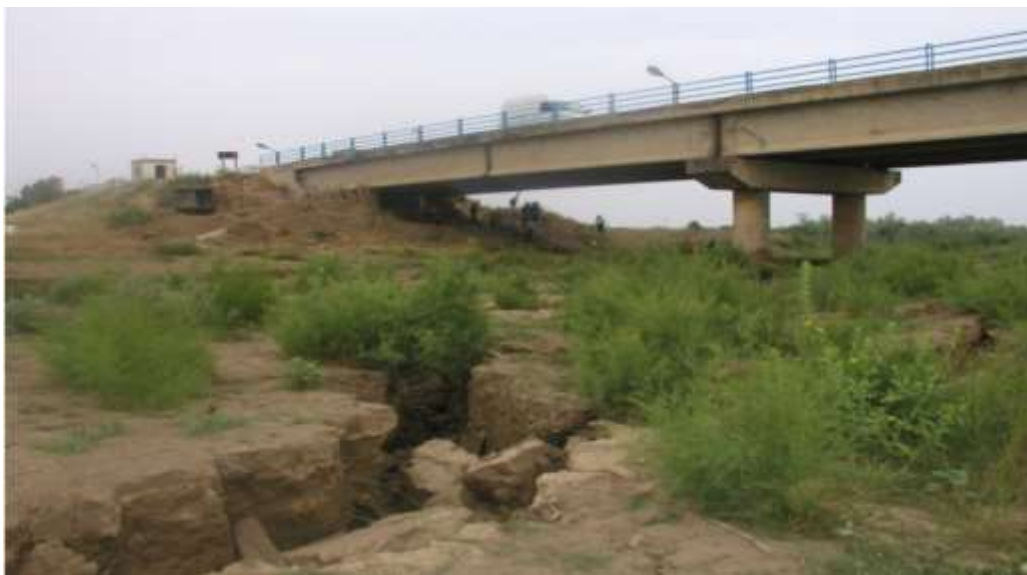
Figure 1.11 : Affaissement de terrain au niveau de l'ouvrage à Oued Isser
