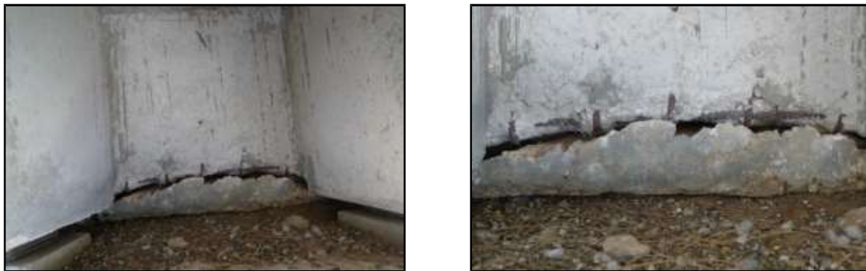
Figure 4.7 : Eclatement de béton
