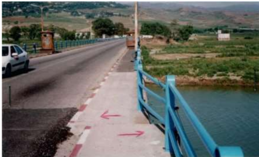
Figure 1 .6 : Déplacement latéral de la pile de pont sur Oued Sebaou
