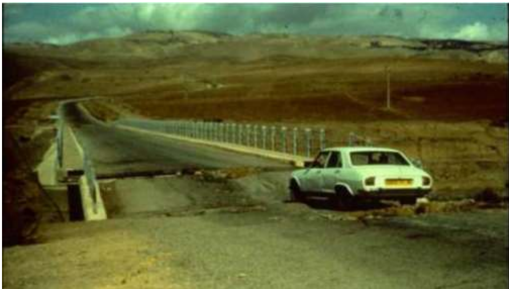
Figure 1. 9 : Affaissement de la dalle de transition (Séisme de Chlef, 1980)
