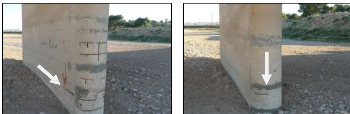
Figure 4.15 : Eclatement de l'enrobage a la base des futs
