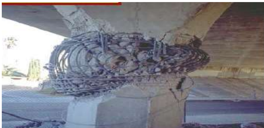
Figure 1 .7 Rupture par manque de confinement d'une pile de pont en béton armé (Northridge, 1994)
