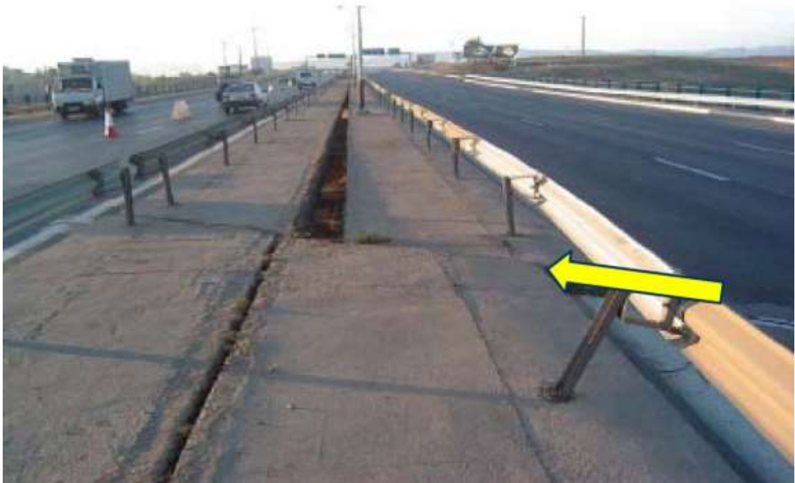
Figure 1.4 : Déplacement horizontal du tablier de pont Ben Aknoun Dar El Beïda (Séisme de Boumerdès, 2003)
