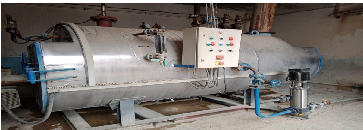
Figure 21 : Chaudière à vapeur de la marque CUENOD (la laiterie Athmani).
