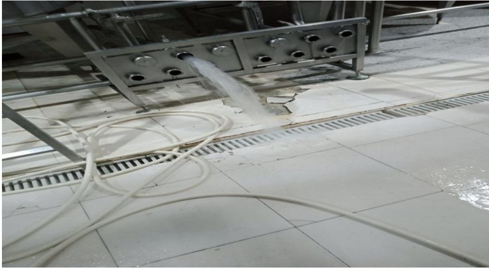
Figure 26 : Rejets des eaux usées dans les réseaux d'assainissements ( La laiterie Athmani ).
