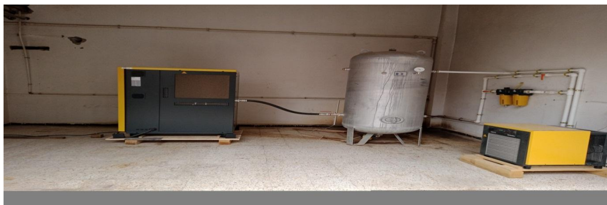
Figure 22 : Compresseur d'air (la laiterie Athmani).
