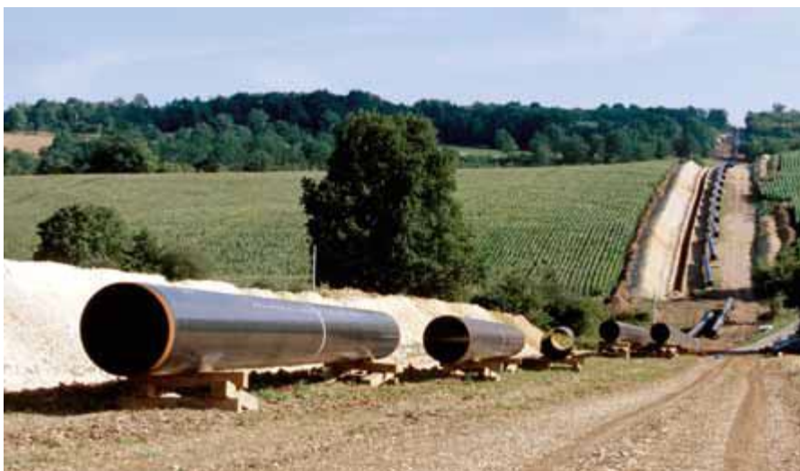
Figure I.6 : Le CO 2 peut se transporter par gazoduc du même type que ceux utilisés pour le transport du gaz naturel. [5]
