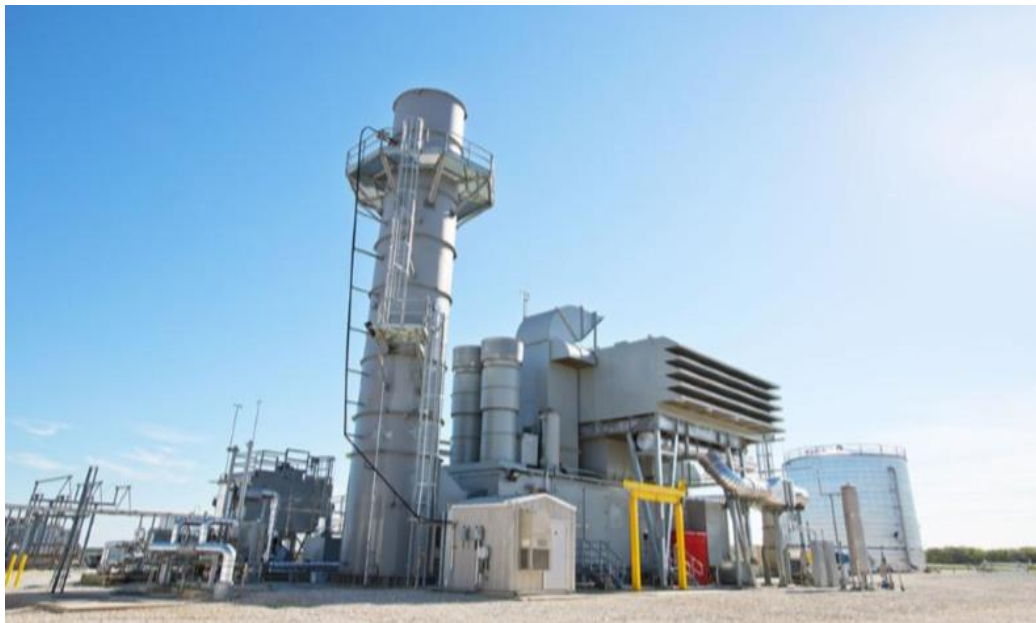
Figure I.1 : Vue extérieure d'une turbine à gaz
