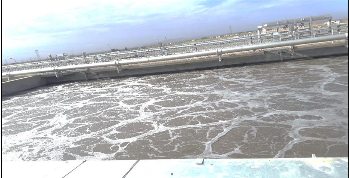
Figure 22. Bassin avec insufflation d'air (Bassin d'aération)
