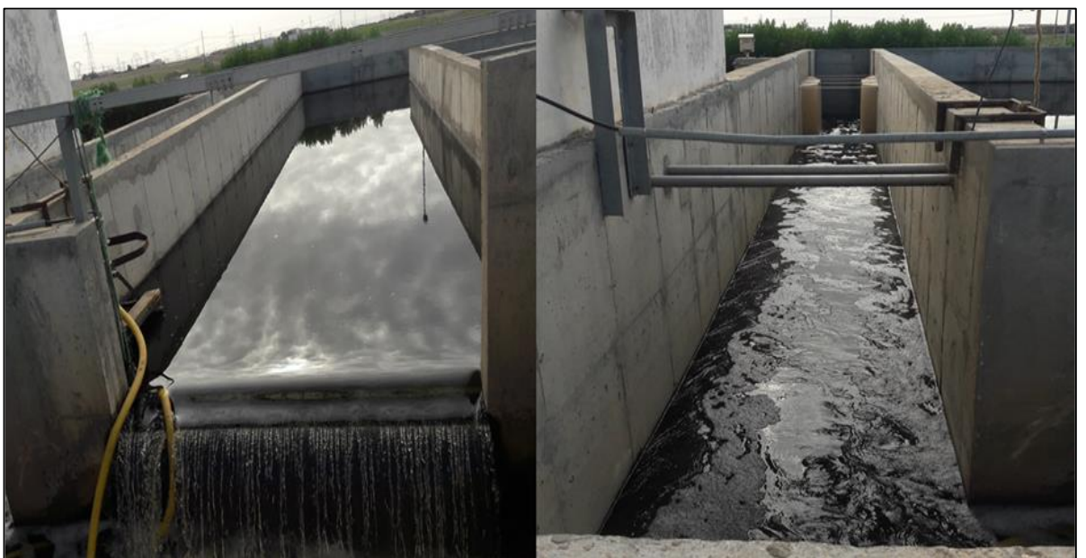
Figure 25. Bassin de chloration
