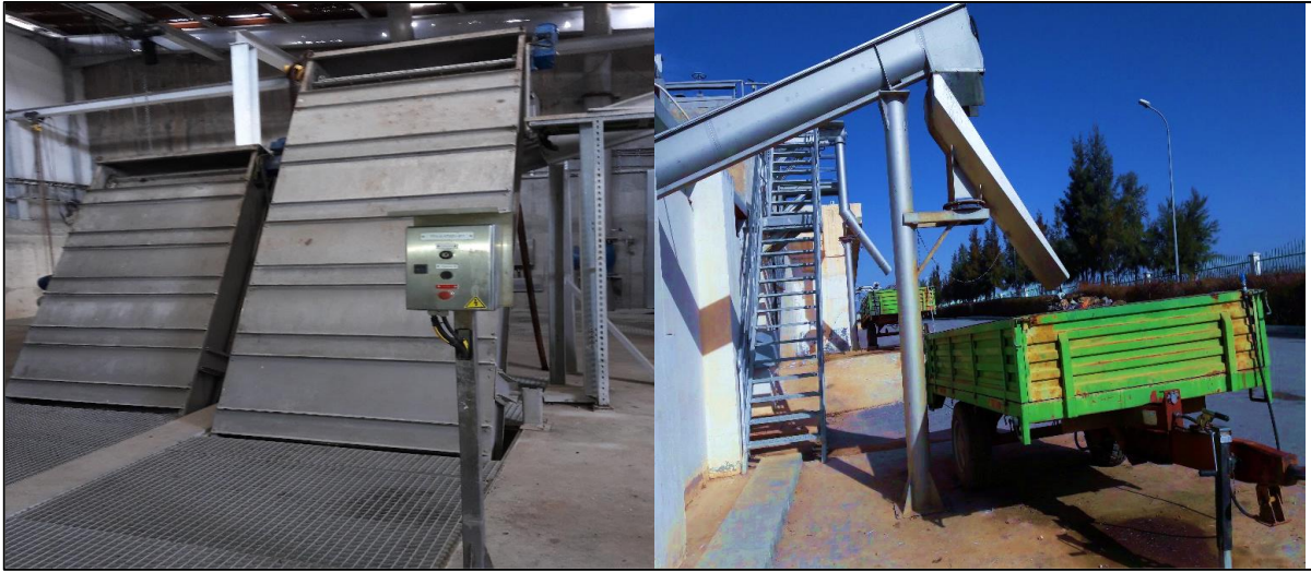
Figure 16. Le Dégrilleur grossier / transporteur des déchets
