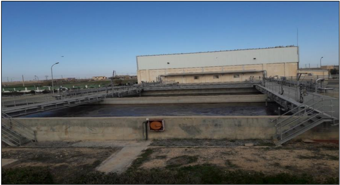
Figure 28. L'épauississeur secondaire (le digesteur aérobie)
