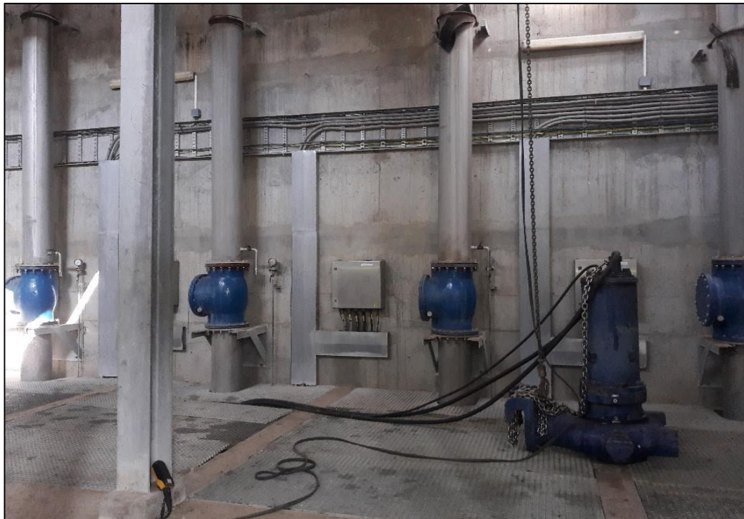
Figure 17. Des pompes de relevage
