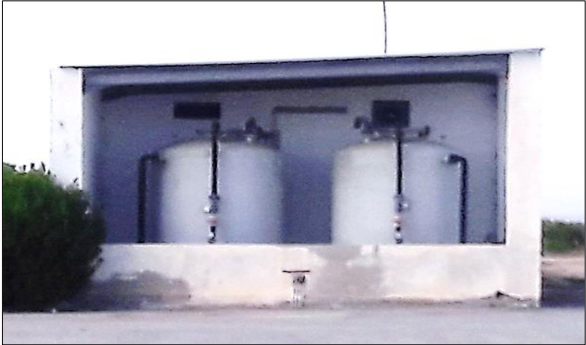
Figure 26. Cuve de stockage et distribution d'eau de javel
