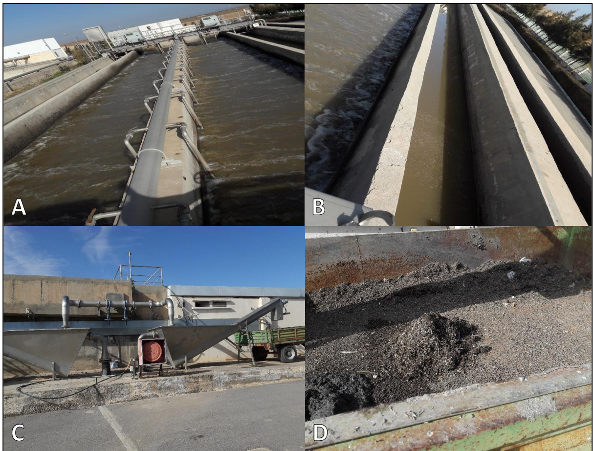
Figure 19. Le dessablage déshuilage (A : Dégraisseur ; B : Dessableur ; C : Classificateur a sable ; D : Sable)
