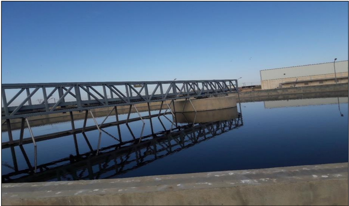
Figure 24. Décanteur secondaire (Clarificateur)
