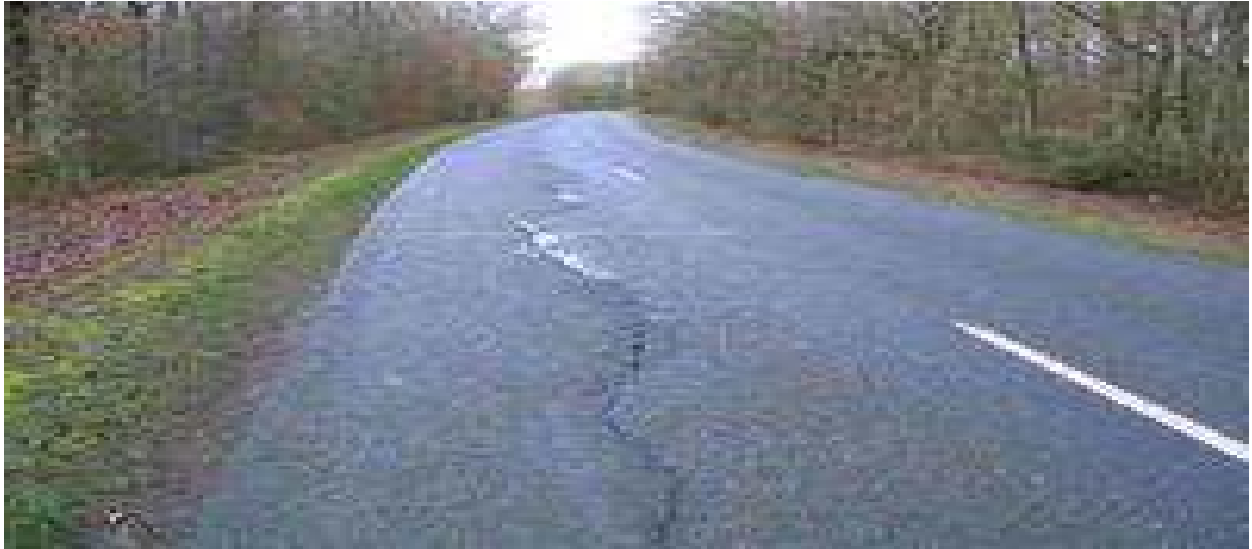
Figure XXIII: Fissuration longitudinale non spécifique aux bandes de roulement
