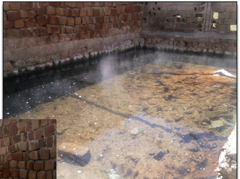
Fig. 13 :Hammam Essalhin ; Griffon 02 Vue interne ; bassin de captage.
