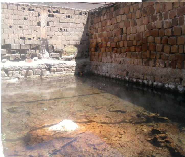
Fig. 14 : Dépôt minérale bassin de captage griffon 02
