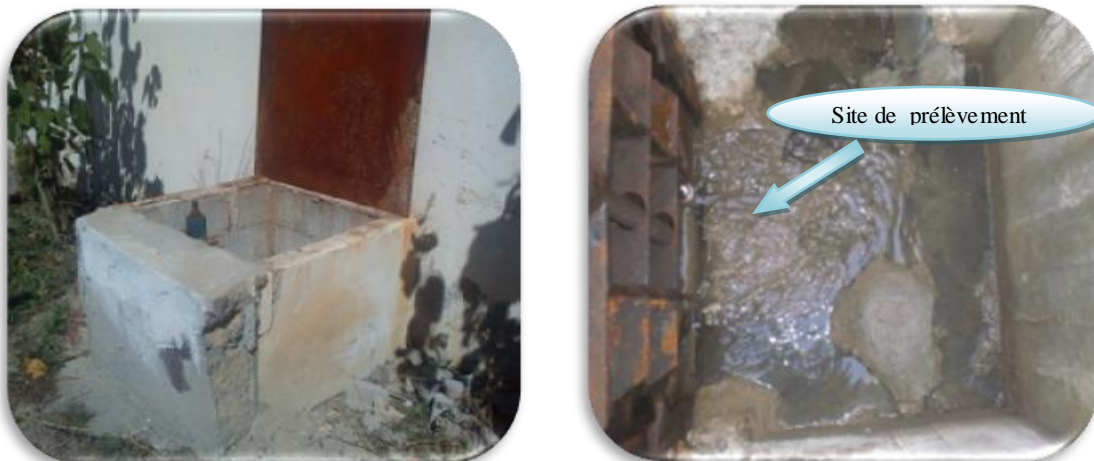
Photographie 02: Collecteur principal de l'établissement hospitalier
