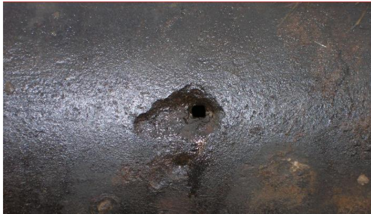
Figure III.6 : La corrosion par piqure
