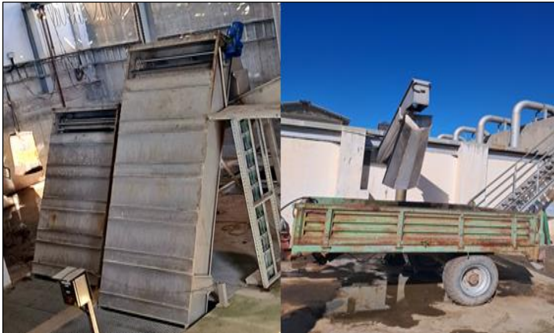
Figure 9. Le Dégrilleur grossier / transporteur des déchets (2024)
