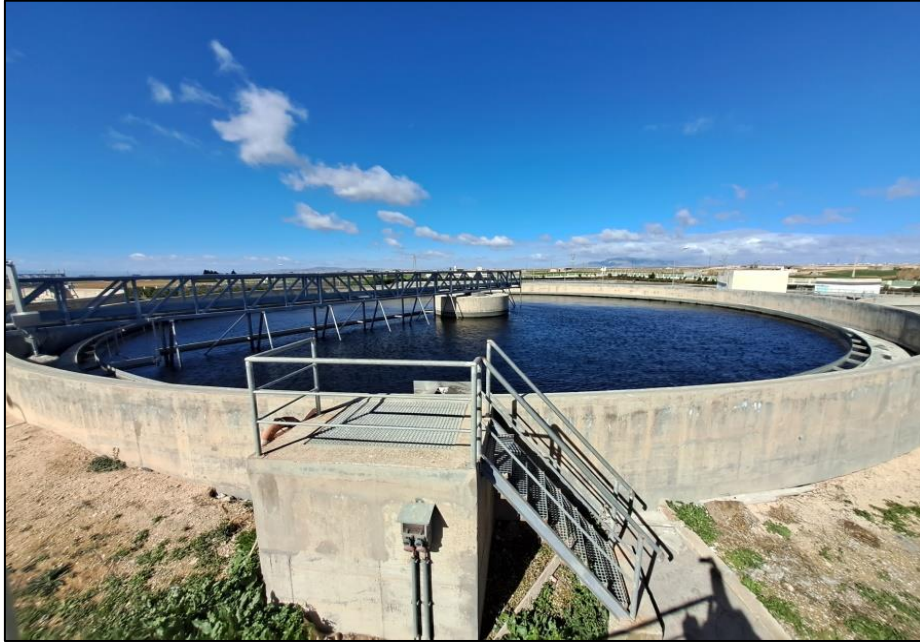
Figure 17. Décanteur secondaire (Clarificateur) (2024)
