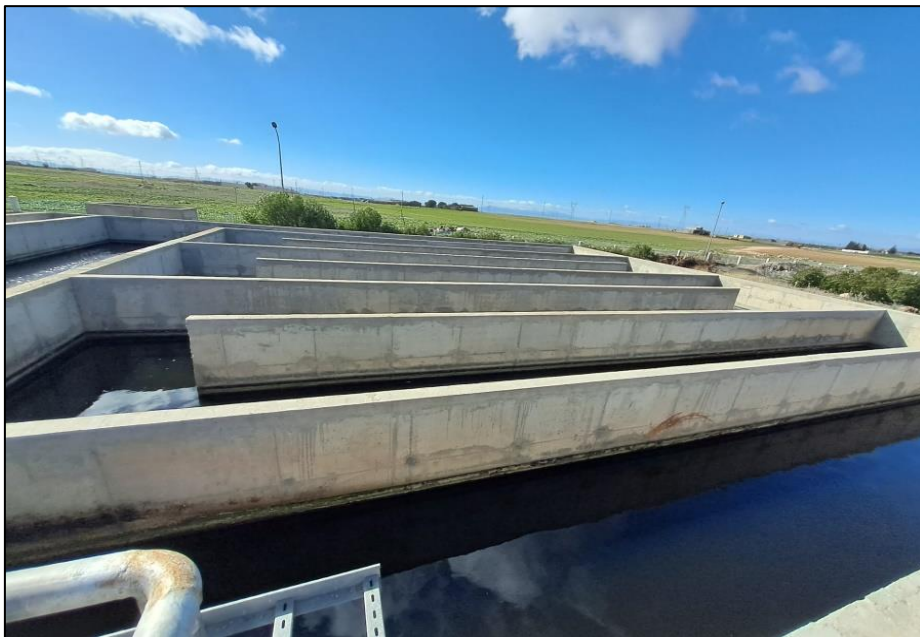
Figure 18. Bassin de chloration (2024)
