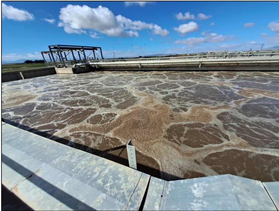
Figure 15. Zone aérobie (Bassin avec insufflation d'air) (2024)
