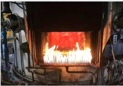
Figure II.6. Four électrique de trempe (ETRAG-Constantine)
