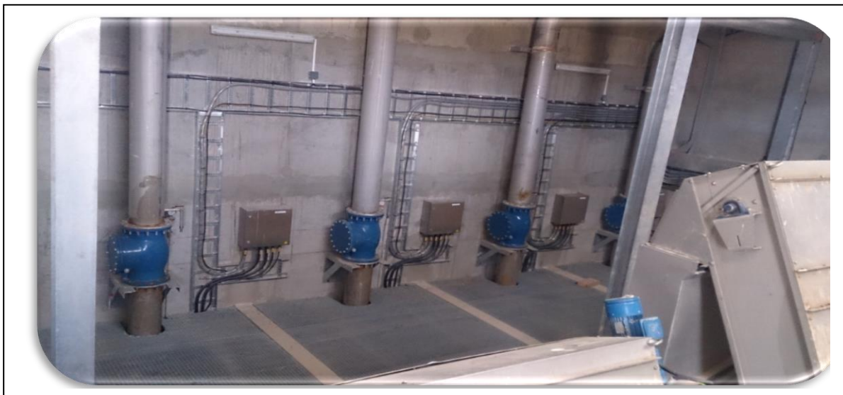
Figure 11 : Les quatre pompes de relevage.
