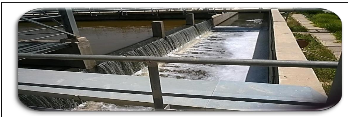
Figure 18 : Le Bassin de dégazage.
