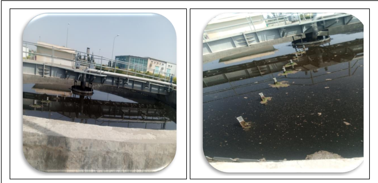
Figure 21 : Les épaisseurs des boues en excès.
