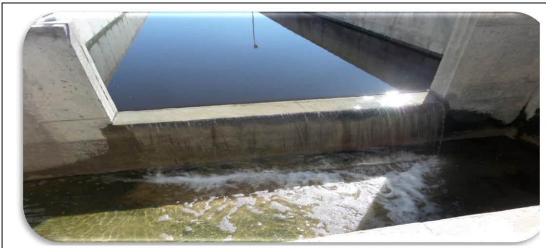
Figure 20 :Le bassin de chloration (la sortie des eaux épuré).
