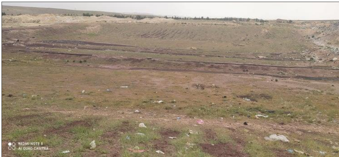
Photo9 : système de drainage
