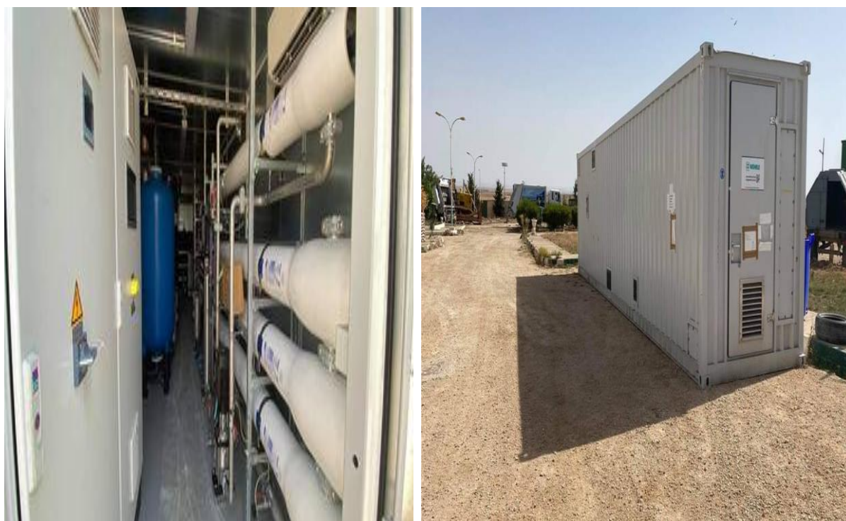
Photo11 : Installation pour le traitement de lixiviat non fonctionnelle.
