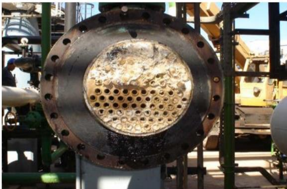
Figure III.04: Bouchage des tubes de l'échangeur de chaleur E.504 [29]
