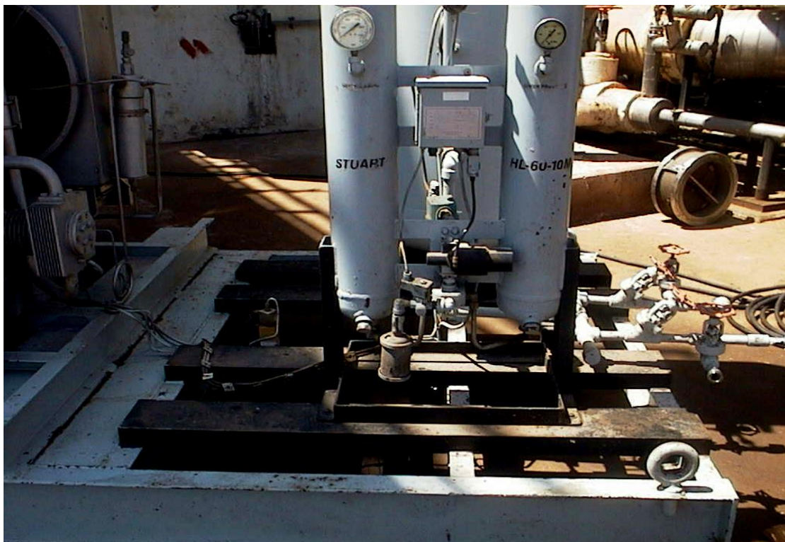
Figure I.09: Photo représente le Compresseur d'air
