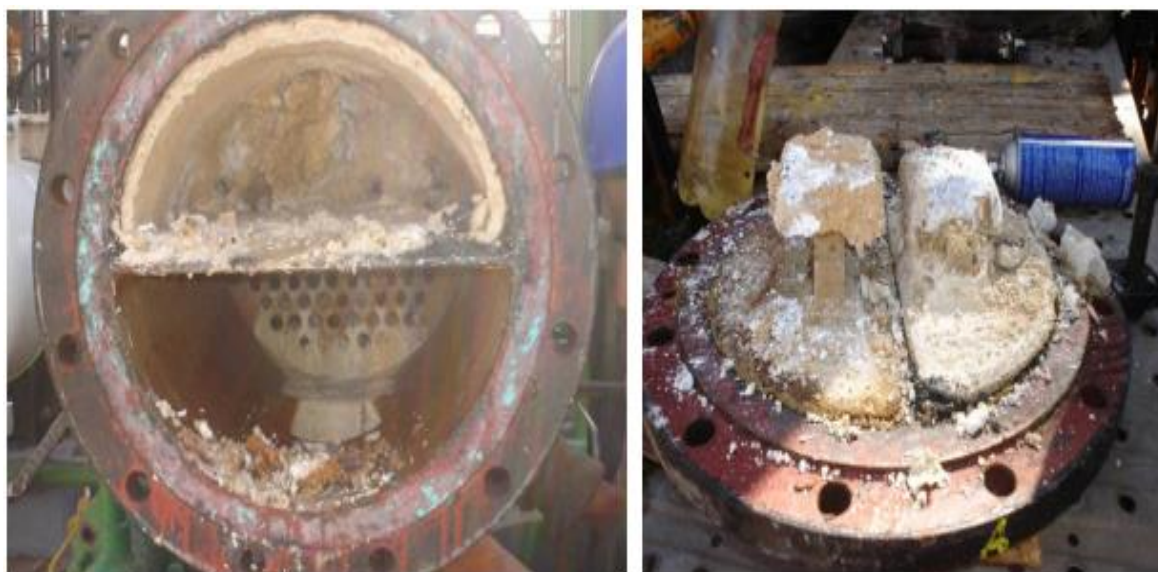
Figure III.03: Les tartres formés sur la boîte de distribution
