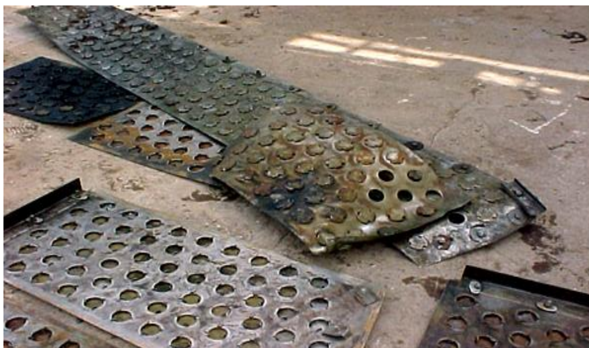
Figure III.05: Bouchage les déversoirs et les clapets de la colonne d'absorption
