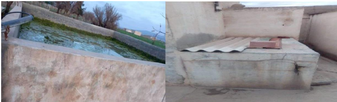
Figure13: Bassin de Remila. Image Gauche (bassin numéro 1), à droite (bassin numéro 2) (photo originale)
