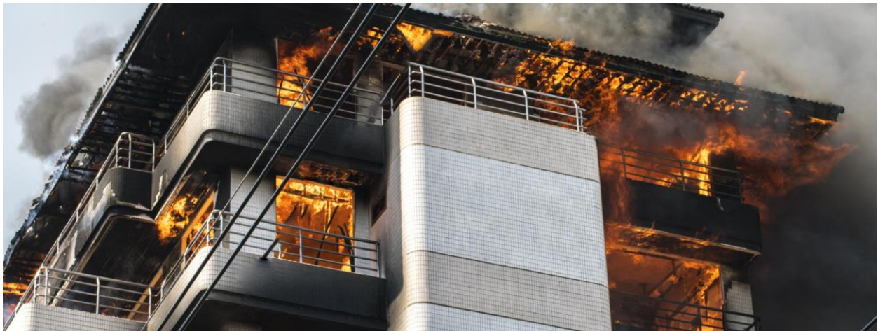
Figure 2-5 : Incendie sur une structure en béton armé
