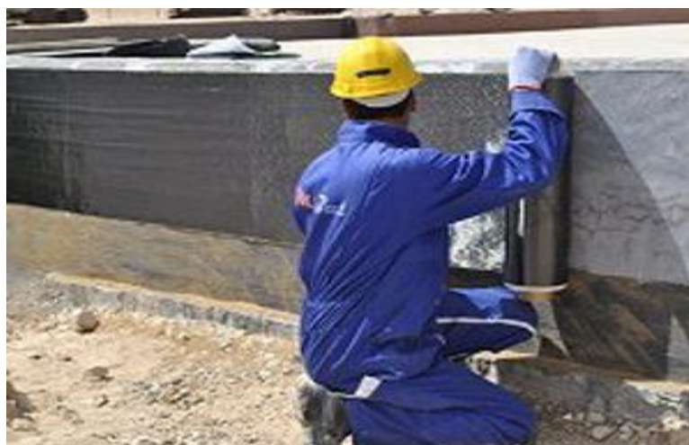
Figure 3-10 : Mur en BA renforcé par matériaux composite
