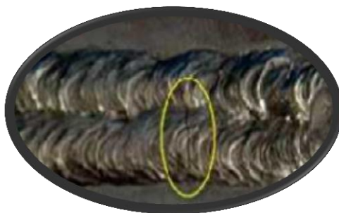
Fig.V.7. Fissure sur un cordon de soudure.
