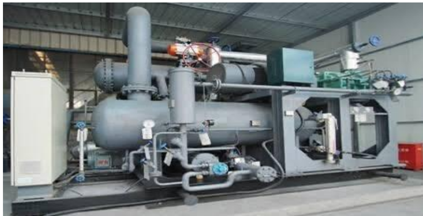
Figure 22 Présentation d'un Générateur (Leroy-Somer, 2022)
