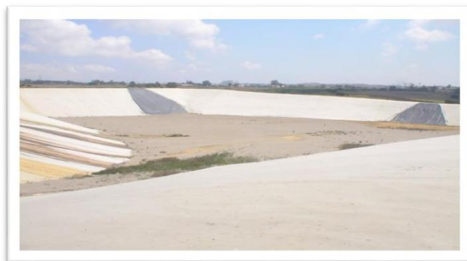
Figure 24 : Casier d'enfouissement des déchets ménagers
