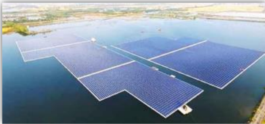
Figure I.7 : Système photovoltaïque flottant sur lac hydroélectrique
