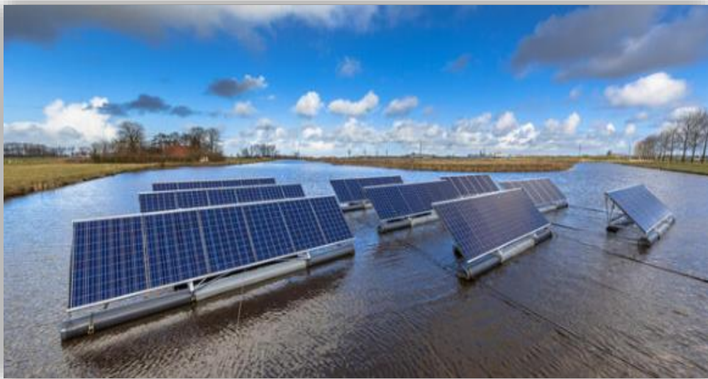
Figure I.1 : Le système photovoltaïque flottante
