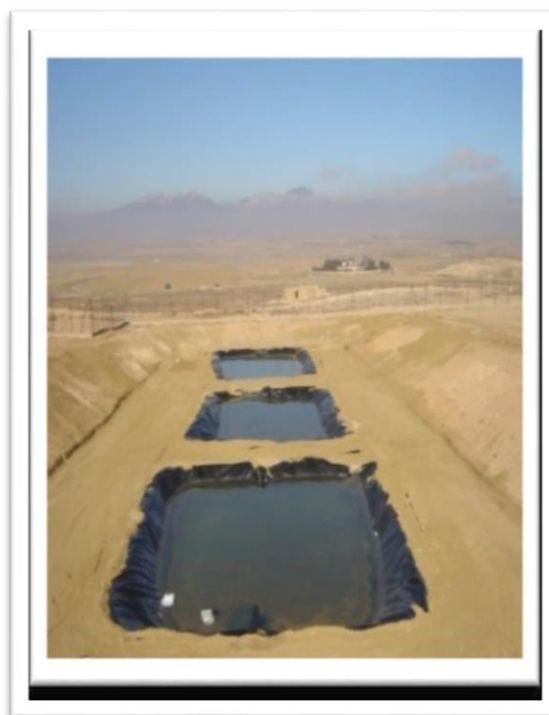
Figure (12) : Bassin de Décantation.
