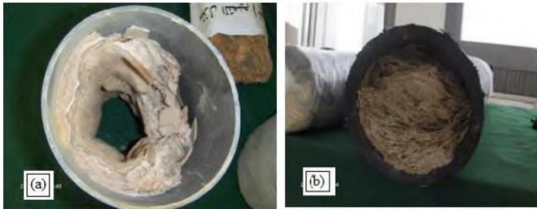
Figure II.11 : Photos des dépôts de tartre de carbonate de calcium dans la canalisation métallique (a) et non métallique (b) [30]
