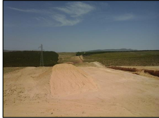
Photo 10 : Détérioration le paysage (Déblai-Remblai)
