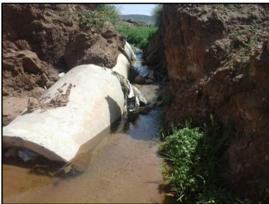
Photo 1: Erosion au niveau Oued El Zhouh traverser par le tracé
