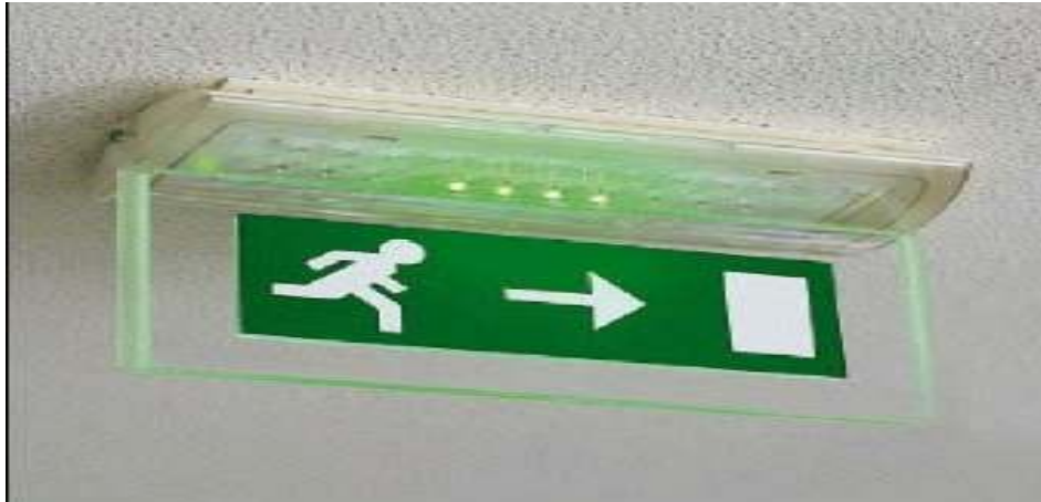
Figure I.20 : Éclairage de secours[21]
