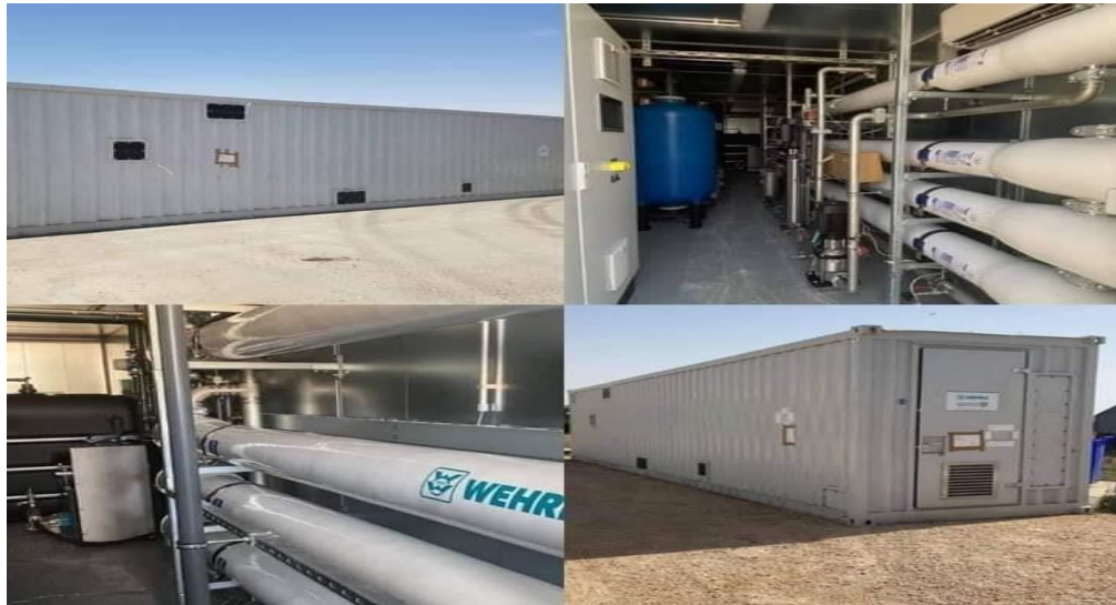
Figure 19: Station de traitement du lixiviat par osmose inverse au niveau du CET de Baghai.
