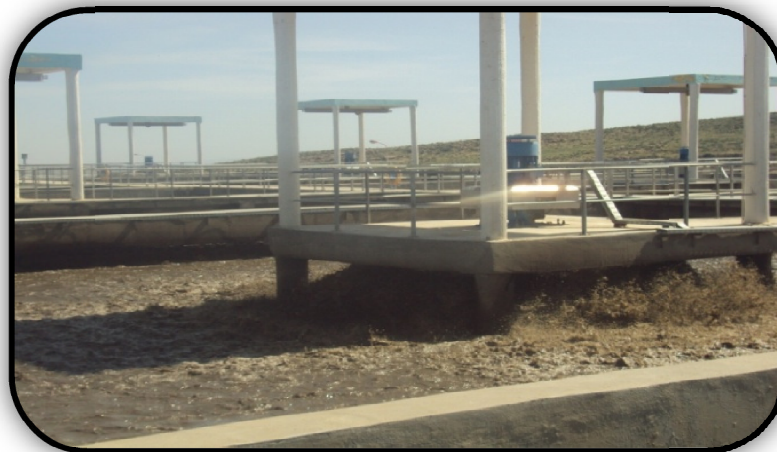
Photo II.2. : Bassin d'aération (STEP Khenchela, 2011)
