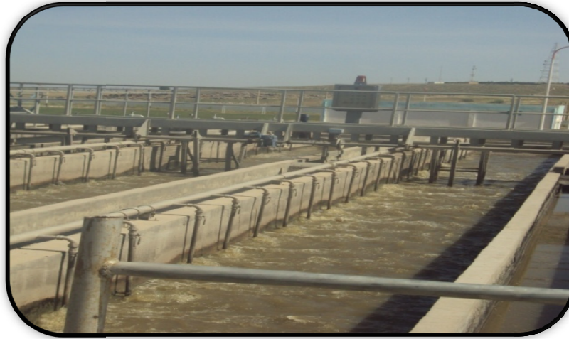
Photo II.1 : Déshuilage / Dessablage (STEP Khenchela, 2011)
