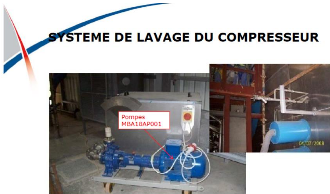
Figure II-21 : Système de nettoyage du compresseur.
