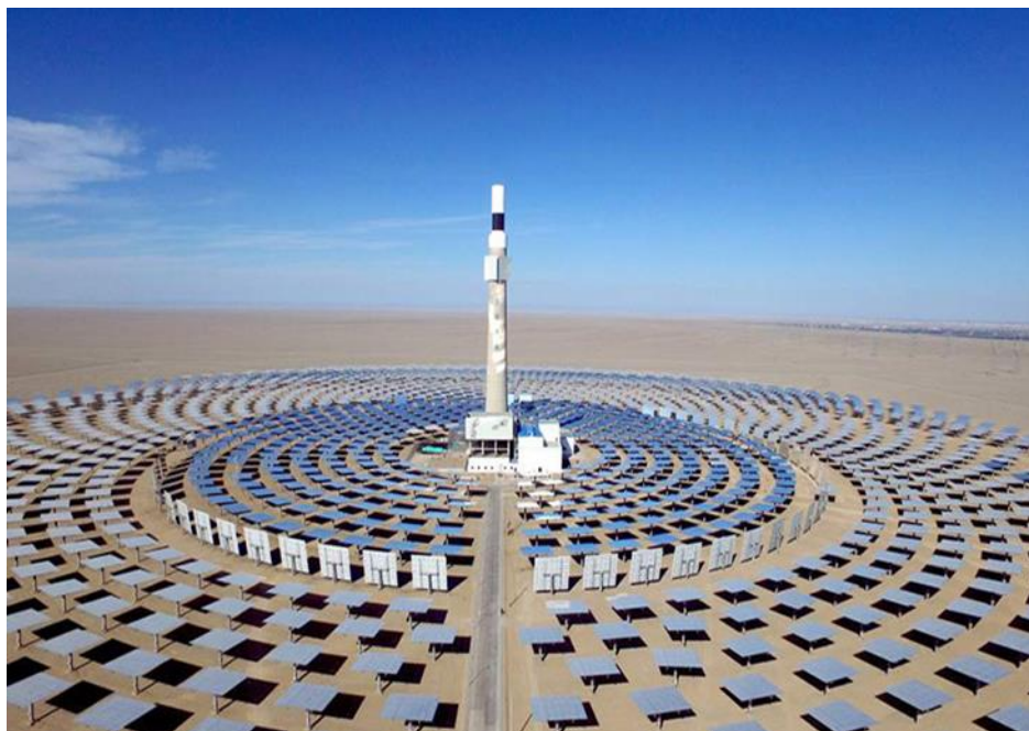
Figure I-6 : Centrale solaire à tour.
