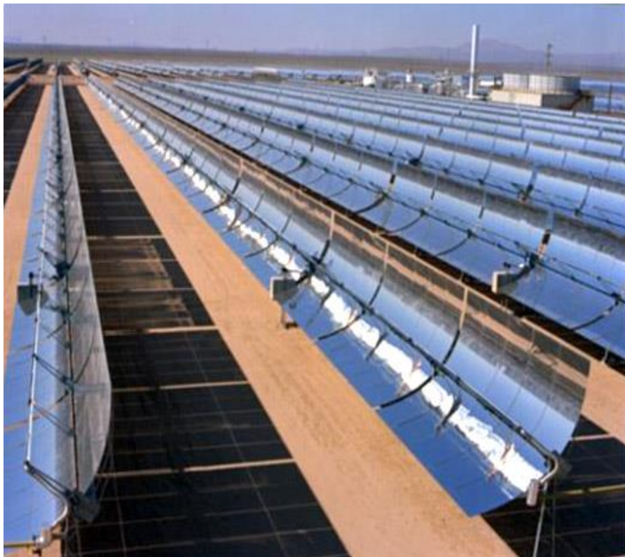
Figure I-4: Centrale constituée de capteur cylindra parabolique.
