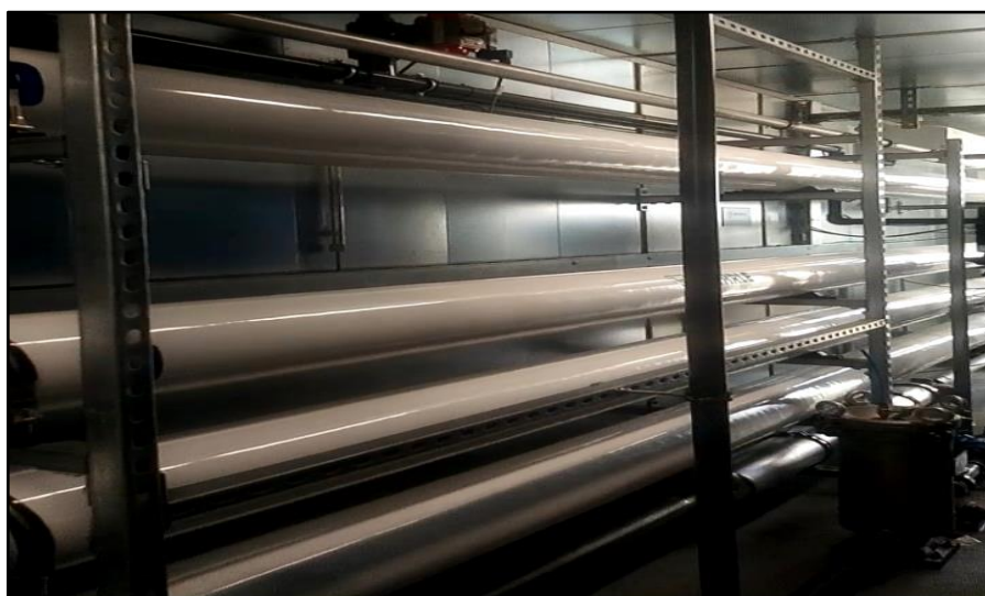
Figure 69 : traitement d'osmose inverse, (CET, 2022).
