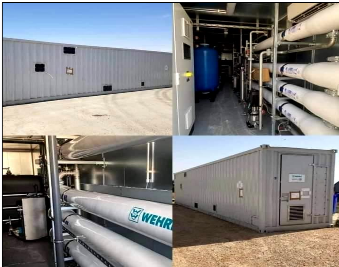
Figure 65 : Station de traitement du lixiviat, (CET, 2022).
