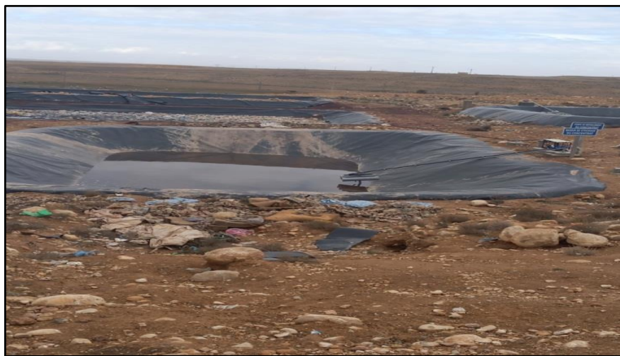
Figure 73 : Drainage de lixiviat hors leurs cheminements vers les bassins de décantation, (CET, 2022).
