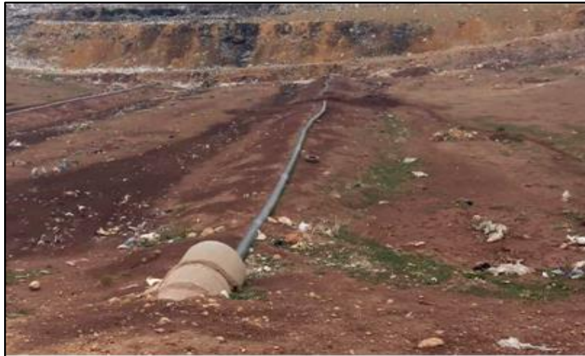
Figure 62 : canalisations du lixiviat, (CET ,2022).
