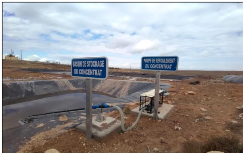
Figure 70 : Bassin de stockage du concentrât,(CET 2022).
