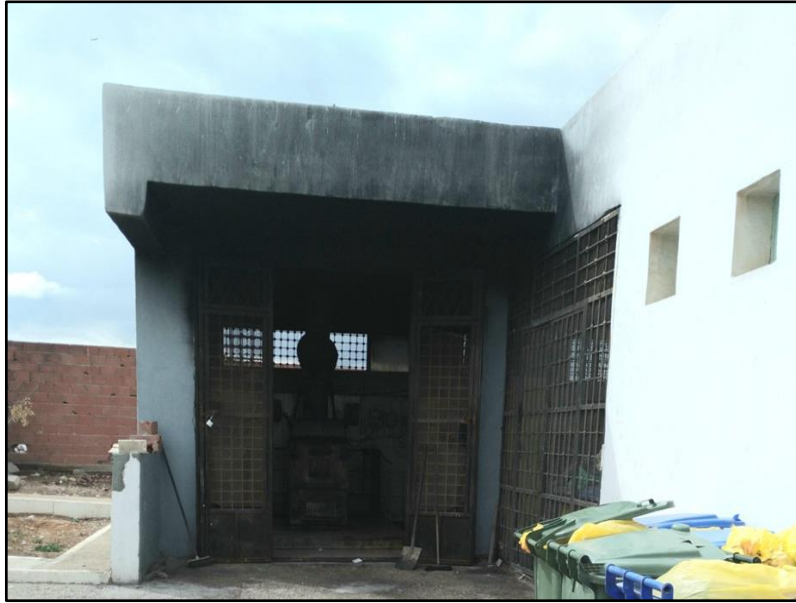
Figure 45 : Salle d'incinération, (CET, 2022).
