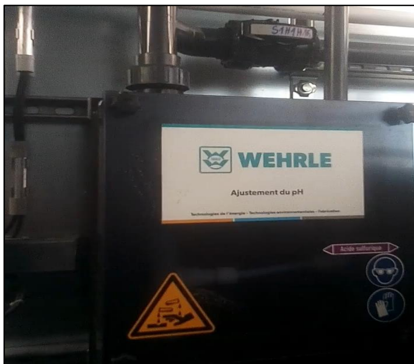
Figure 68 : Cuve d'ajustement du pH, (CET, 2022).
