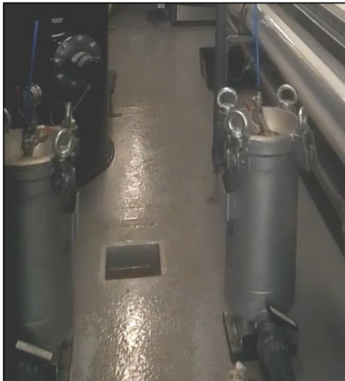
Figure 67 : Filtres à poche et filtre à cartouche, (CET ,2022).
