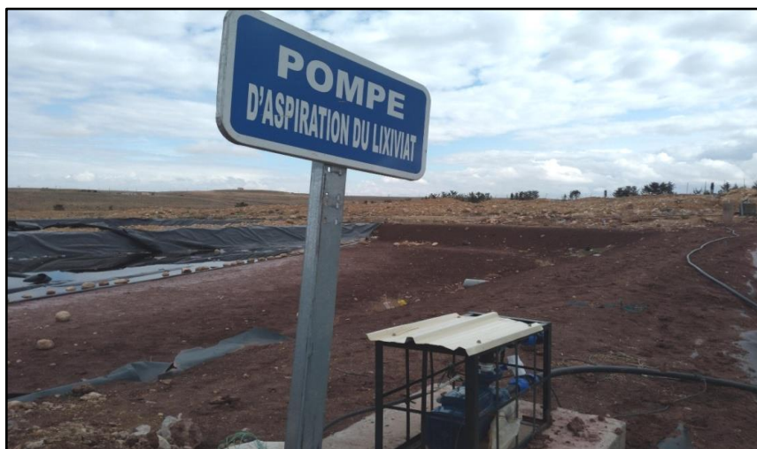
Figure 64 : Bassin d'homogénéisation, (CET, 2022).
