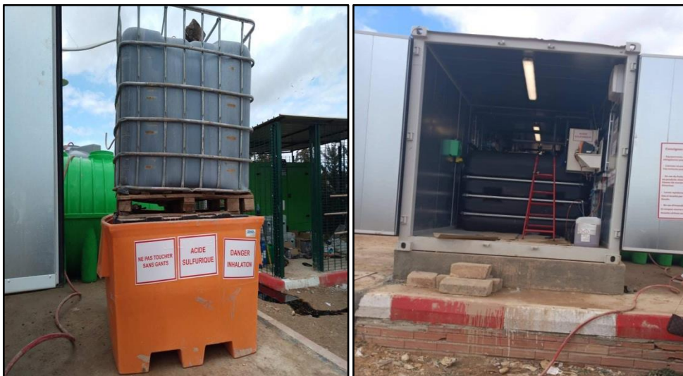
Figure 30 : Station de traitement du lixiviat, (CET, 2022).
