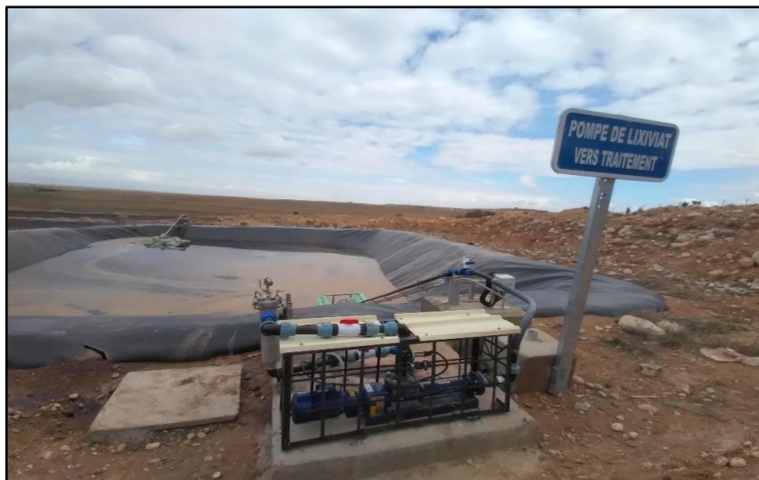
Figure 63 : Bassin de stabilisation, (CET ,2022).
