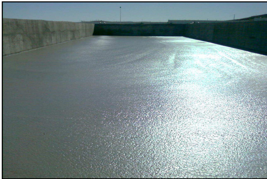
Figure 7. Photographie d'un lit de séchage, station d'épuration de KHENCHELA.
