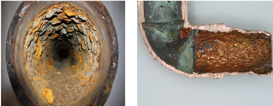
Figure(I.8) : corrosion érosion.
